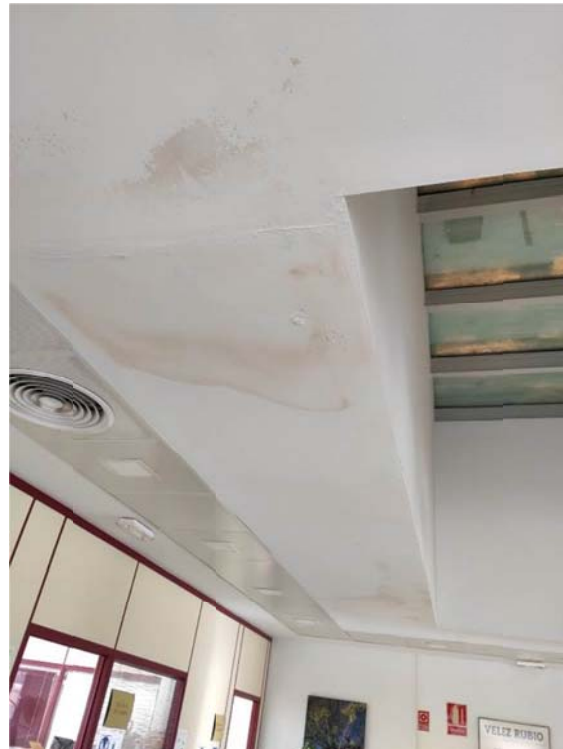
Fotografía Nº 04: Humedades de lucernario.
