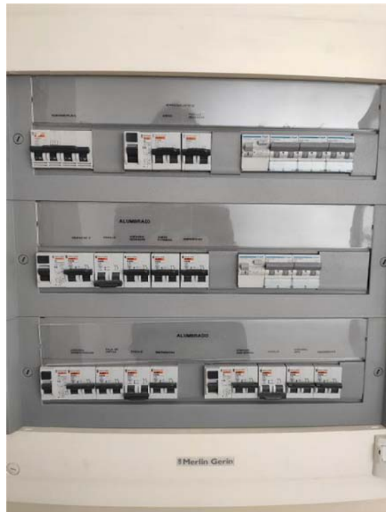
Fotografía N° 12: Subcuadro eléctrico de planta primera y segunda.
