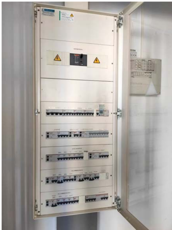
Fotografía N° 11: Cuadro general de mando y protección, planta baja.
