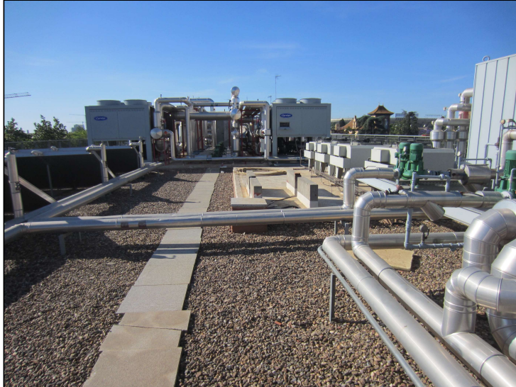
Foto 1. Equipos a sustituir en cubierta.
