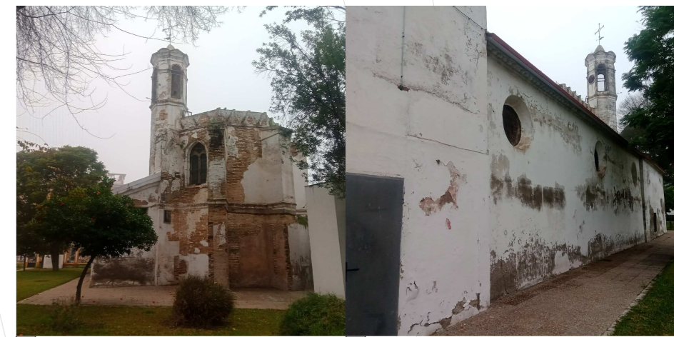
25 Vista general del exterior del ábside de la iglesia. Falta de revestimiento generalizada. Manchas en el testero de la nave lateral. Verdín y vegetación en las almenas sirias y contrafuertes. 26 Vista general del lateral de la iglesia. Notables manchas de humedad y desperfectos en revestimientos. Desconchados y verdín.
