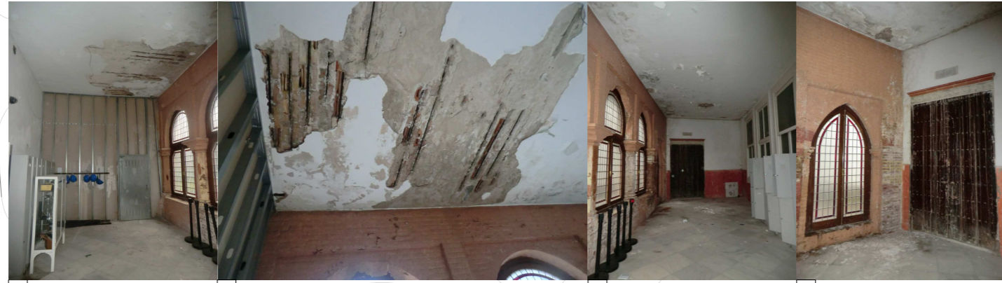
5 Galería neo-mudéjar clausurada. Desprendimiento de pintura y revestimientos en techo provocado por la oxidación de los aceros del forjado generado por la entrada de humedades. Daños de la fachada causados por la aplicación de pintura plástica no transpirable. Presenta un aspecto general de abandono. 6 Galería neo-mudéjar clausurada. Desprendimiento de pintura y revestimientos en techo y paredes generado por la entrada de humedades. Daños grave de las carpinterías de la puerta neomudéjar y puerta de la iglesia.
