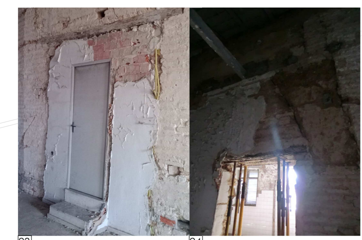
23 Dependencias antigua clausura. Huecos entre estancias apeados. Falta de revestimiento que muestra los distintos aparejos del antiguo muro, huecos cegados, dinteles antiguos y conductos de instalaciones. En general en un estado de conservación muy deteriorado. 24
