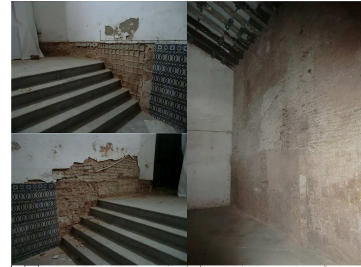
21 Desprendimiento de revestimientos, pinturas y azulejos, humedad generalizada. 22 23 Nave lateral. Se ha retirado el revestimiento en mal estado, aunque aún muestra señales de humedad.
