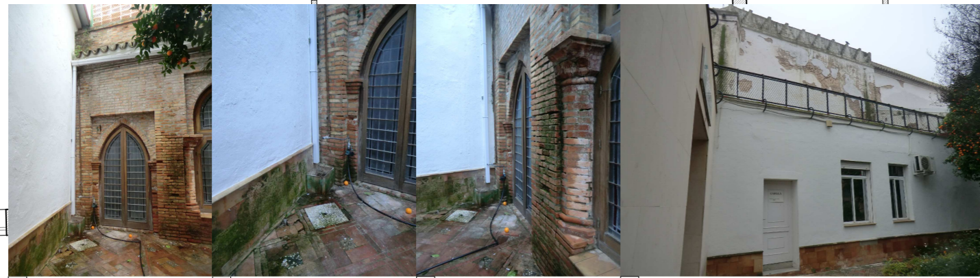
1 Encuentro de iglesia con galería neomudéjar. Se aprecian manchas de humedades en ambos muros, en el zócalo, etc... En la parte superior se observa la fábrica levantada sin la traba adecuada, sin ajustarse a las condiciones de seguridad necesarias, al tiempo que el nivel de calidad no se ajusta a la galería neomudéjar.
