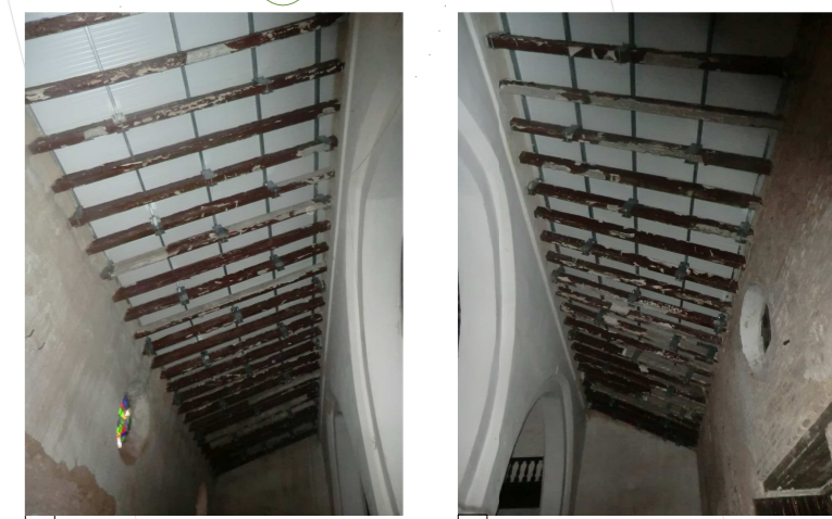
29 Cubiertas de las naves laterales. Actuación de emergencia ejecutada en chapa y acero sobre vigas de maderas. Las vigas se encuentran aún en un estado lamentable de suciedad y deterioro. Una actuación claramente temporal. 30
