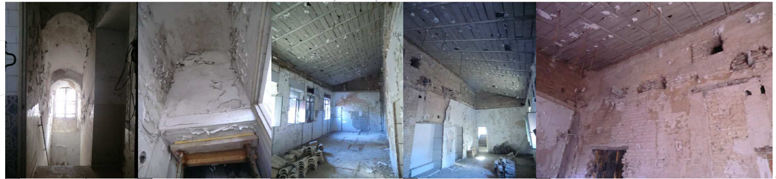
10 Escalera acceso. Estado de abandono, deterioro de revestimientos y suciedad. 11 Techo escalera de acceso. El hueco de entrada se encuentra arriostrada. 12 Antiguo baños/lavadero de Clausura. Estado de abandono y deterioro de revestimientos y suciedad. 13 Cubierta de viguetas auto-resistente y bovedillas. 14 Detalle baños/lavadero. Vigas de arriostamiento autoresistentes atraviesan el muro central. Se ha retirado los revestimiento dejando visto los distintos aparejos y antiguo huecos del muro.
