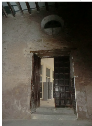
24 Muro de la iglesia, adosado a la dependencias de las religiosas. Notable muestras de humedad en la base del muro, encuentro de la cubierta y entorno a los huecos.
