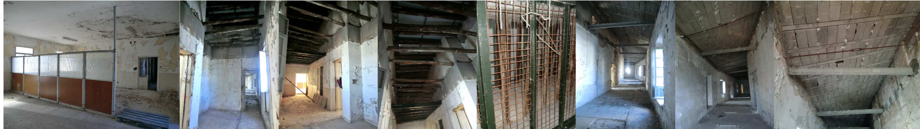
15 Sala planta alta. Estado de abandono y deterioro de revestimientos, suciedad, excrementos, humedades en falso techo. 16 Pasillo de las antiguas dependencias: Revestimientos muy deteriorados por la entrada directa de agua por la rotura de los vidrios. Se aprecian las antiguas vigas de madera que arriostran los muros y la intervención de emergencia de la cubierta del cuerpo sobre la entrada principal ejecutada en acero y chapa. 17 18 Dependencias antigua clausura. Se aprecian unas antiguas barras de acero que arriostran los muros, las cuales han sido complementadas recientemente con viguetas auto-resistentes. Solución que no parece haber solucionado el problema ya que existe un notable desplome en los muros. En general un estado de conservación muy deteriorado. 19 20 21 22
