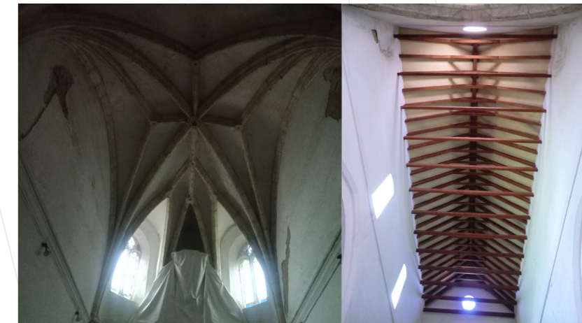
27 Vista de la bóveda del presbiterio. Se aprecia suciedad en los nervios y el mal estado de los revestimientos de los laterales y plementos de la bóveda. 28 Vista de la nave central. Cerchas en forma de artesas. Importante entrada de humedad en el encuentro con la bóveda del presbiterio.
