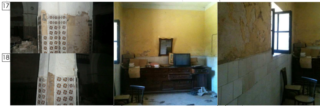
17 Pilares centrales de la nave, con presencia de fisuras y graves deformaciones en el revestimiento del zócalo y enlosado. 18 Desprendimiento de revestimientos, pinturas y azulejos, humedad generalizada en paredes, suciedad y degradación del ámbito. 19 20
