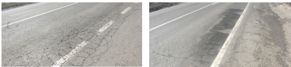
Hundimiento del firme y formación de fisuración
