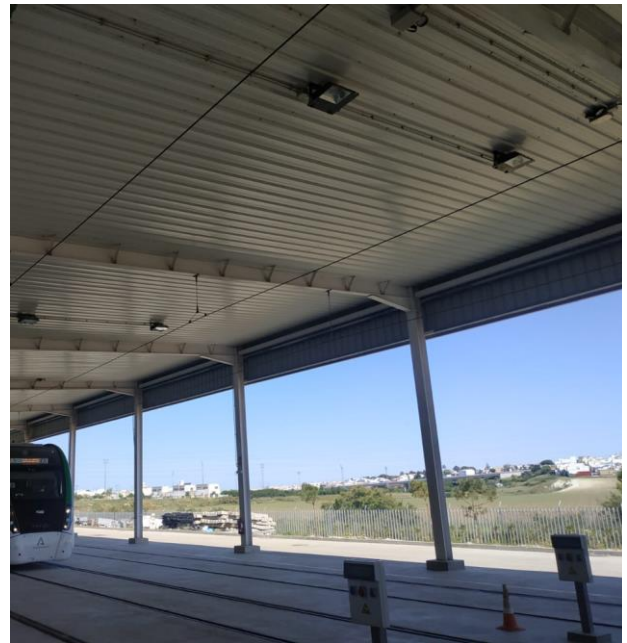
Ilustración 4. Proyectores iluminación zona de cocheras
