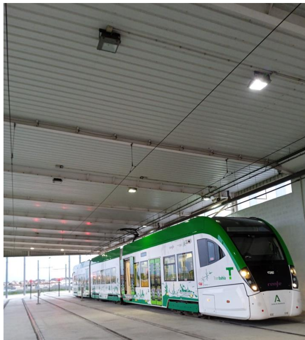
Ilustración 2. Proyectores iluminación zona de cocheras
