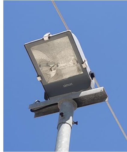
Ilustración 28. Iluminación andén paradas
