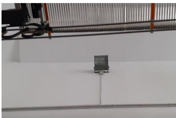
Ilustración 17. Iluminación zona Almacén
