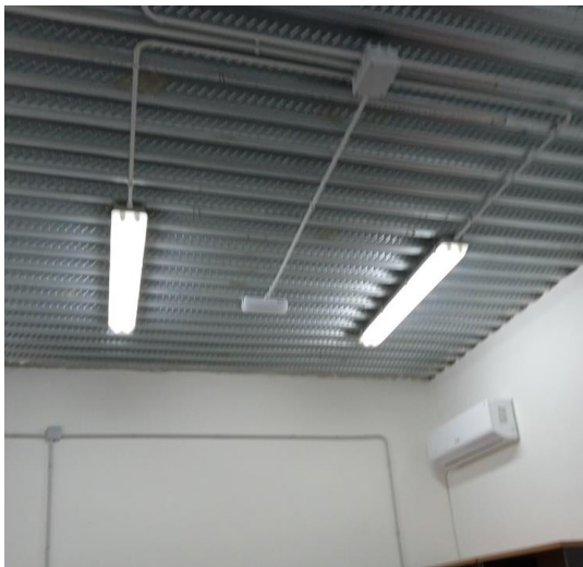
Ilustración 20. Iluminación salas técnicas
