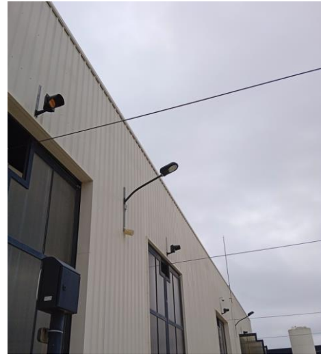
Ilustración 22. Iluminación exterior recinto Talleres y cocheras
