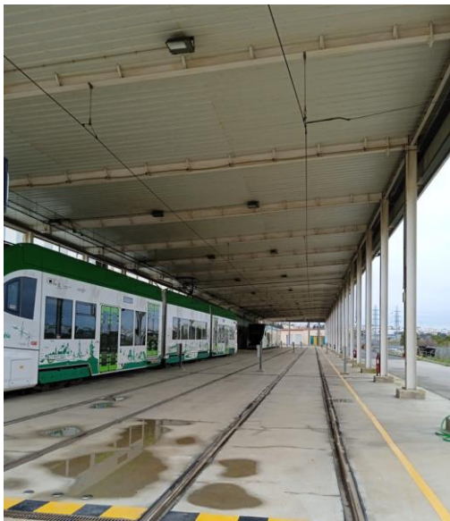
Ilustración 5. Proyectores iluminación zona de cocheras
