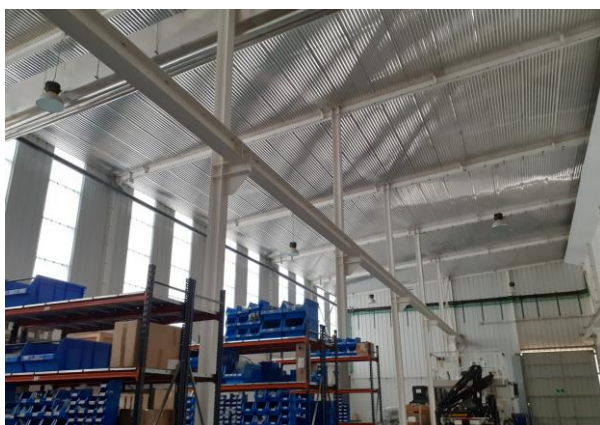
Ilustración 15. Iluminación zona Almacén
