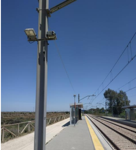
Ilustración 27. Iluminación andén paradas
