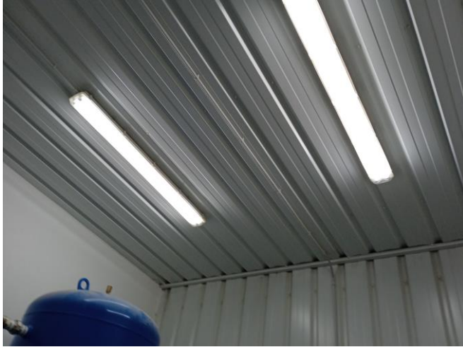
Ilustración 18. Iluminación salas técnicas
