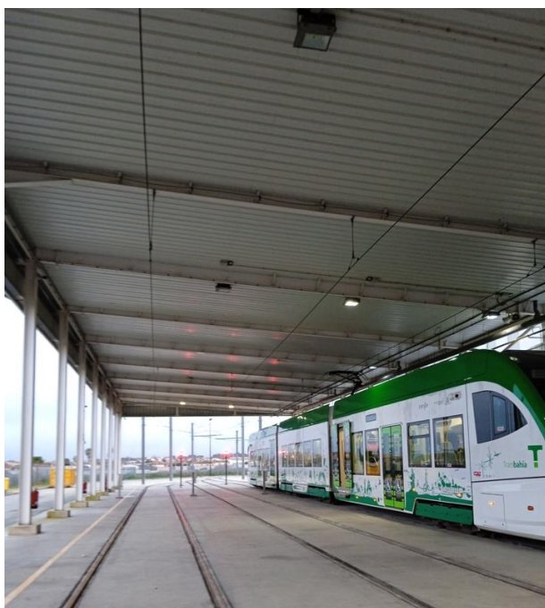
Ilustración 1. Proyectores iluminación zona de cocheras
