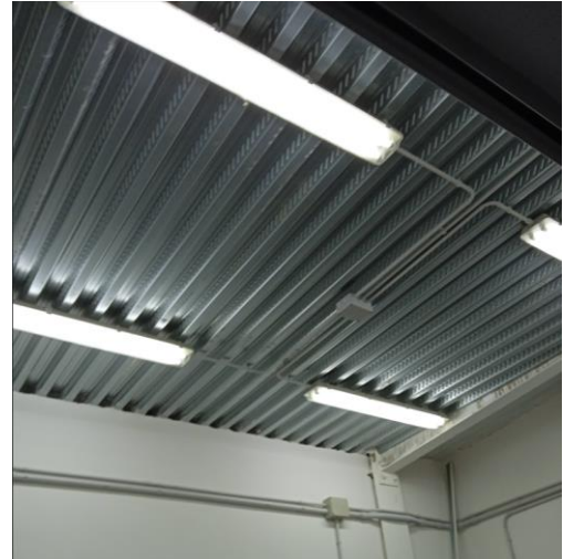
Ilustración 19. Iluminación salas técnicas
