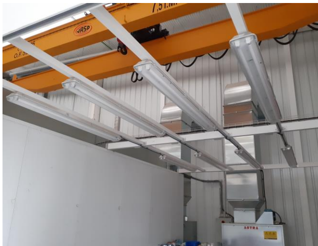
Ilustración 14. Iluminación zona Taller
