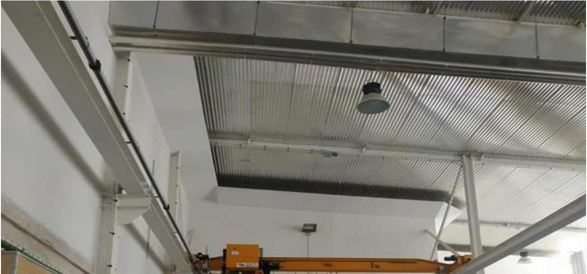
Ilustración 7 Iluminación zona Almacén
