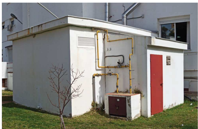
Sala de calderas
