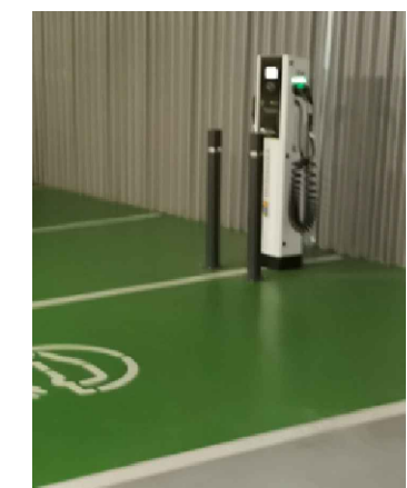
DETALLE BOLARDOS Y CARGADOR YA INSTALADOS *SE INSTALARÁN EN LAS NUEVAS PLAZAS ELEMENTOS EQUIVALENTES
