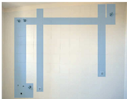
23. Bandas por donde discurren las instalaciones. Cocina.
