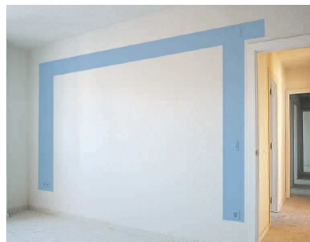
24. Bandas por donde discurren las instalaciones. Salón.
