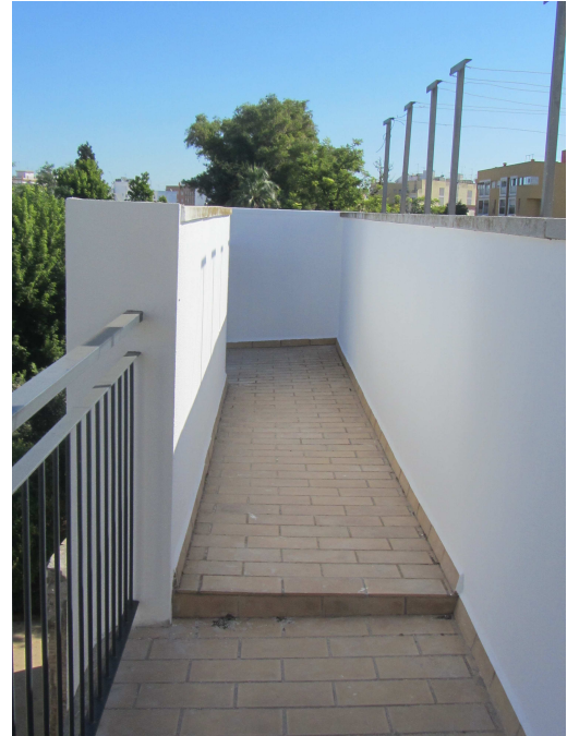
Desnivel en última galería exterior
