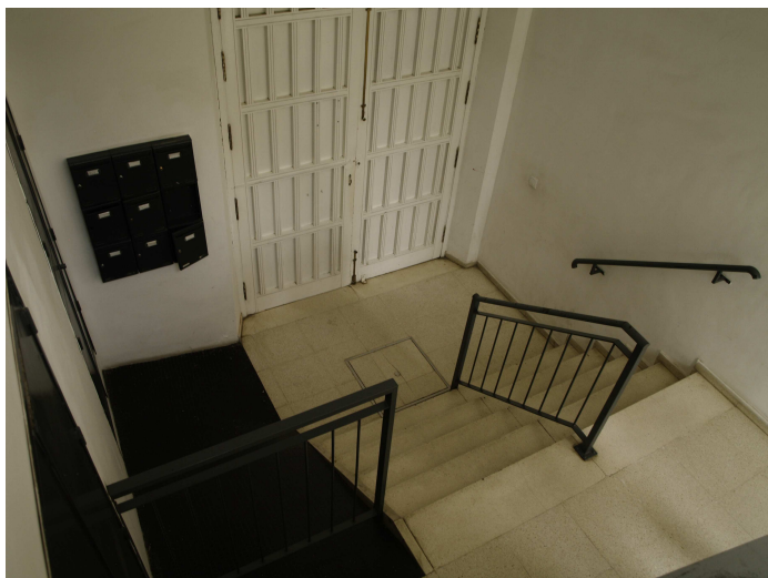
Desniveles en planta baja
