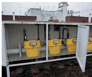
20. BATERÍA DE CONTADORES Y LLAVES DE CORTE.
