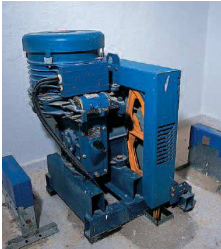
13. MAQUINARIA DE ASCENSOR.
