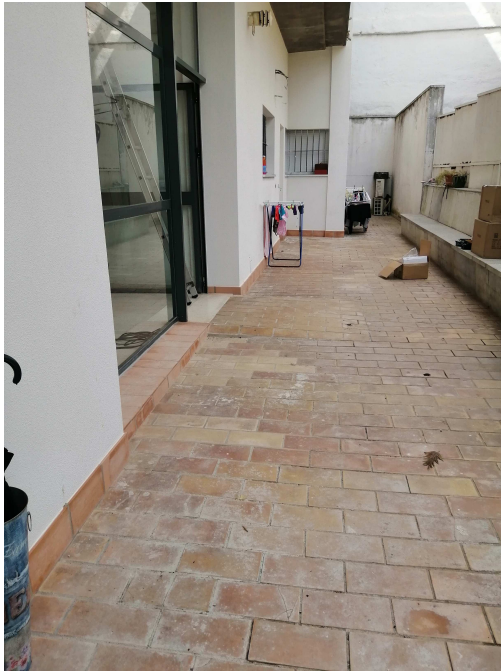
Desnivel entre zona común y cota de patio donde se accede a viviendas
