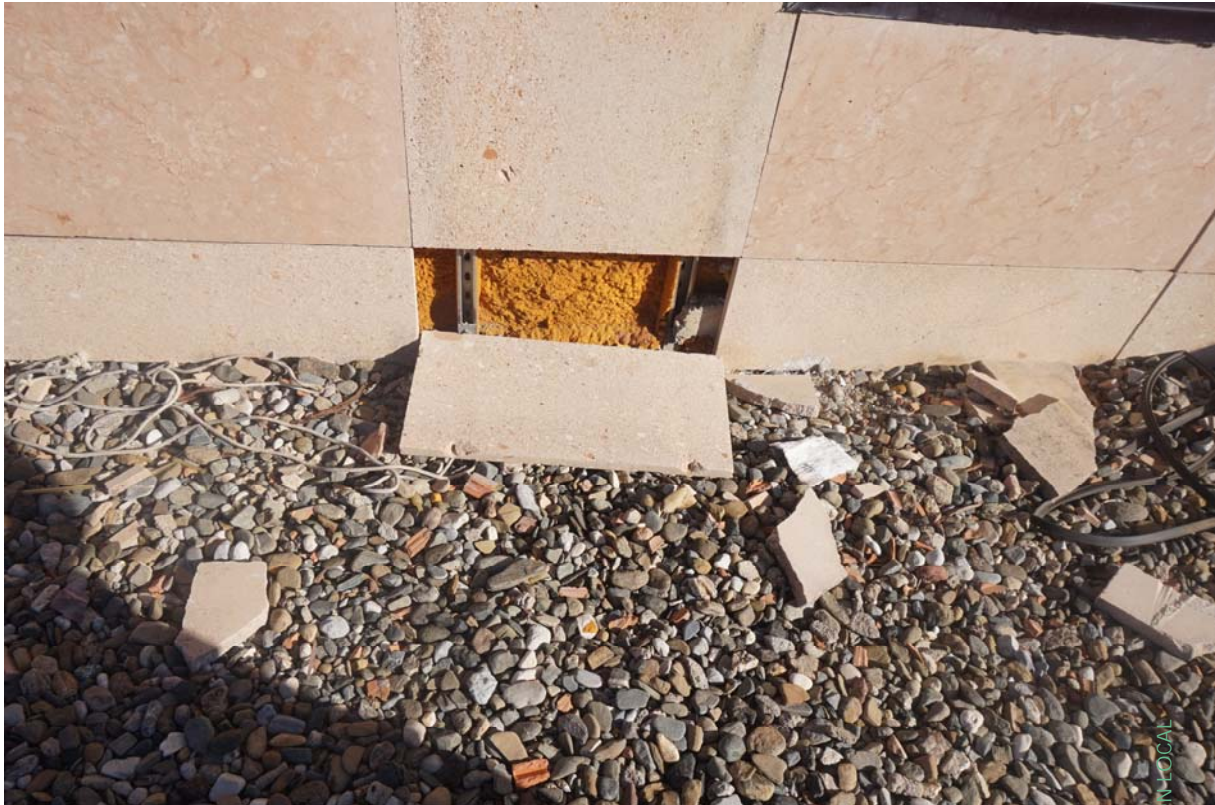
Patología del sistema de aplacado de fachada por la incorrecta elección de anclajes
