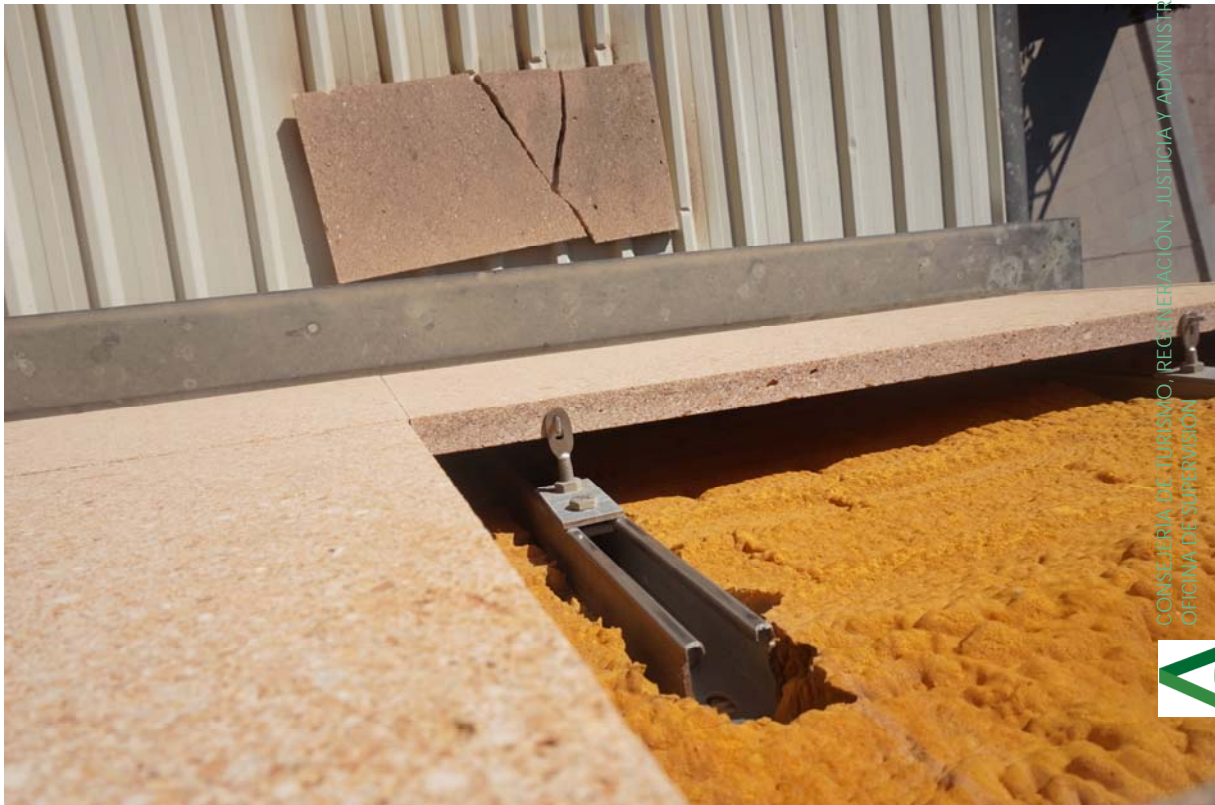
Pérdida de material de fachada y desplome hasta una cubierta del nivel inferior
