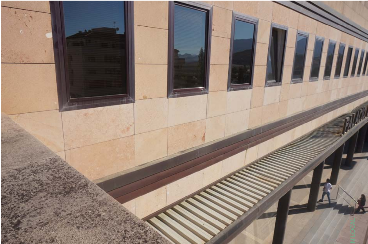
Fachada sur del edificio con la seriación de huecos situados en el mismo plano de la terminación de fachada
