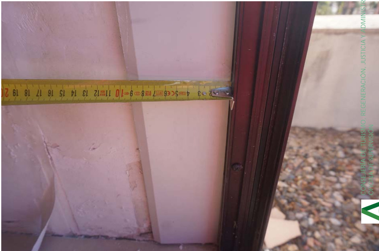
Patología en los huecos por presencia de humedad en dinteles y mochetas
