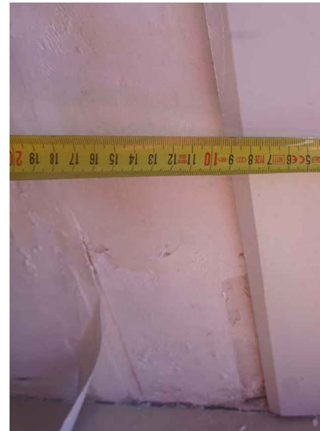
FOTO 5: PRESENCIA DE HUMEDAD EN MOCHETA
