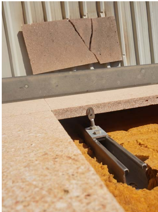
FOTO 3: CHAPA ONDULADA DETERIORADA POR IMPACTO
