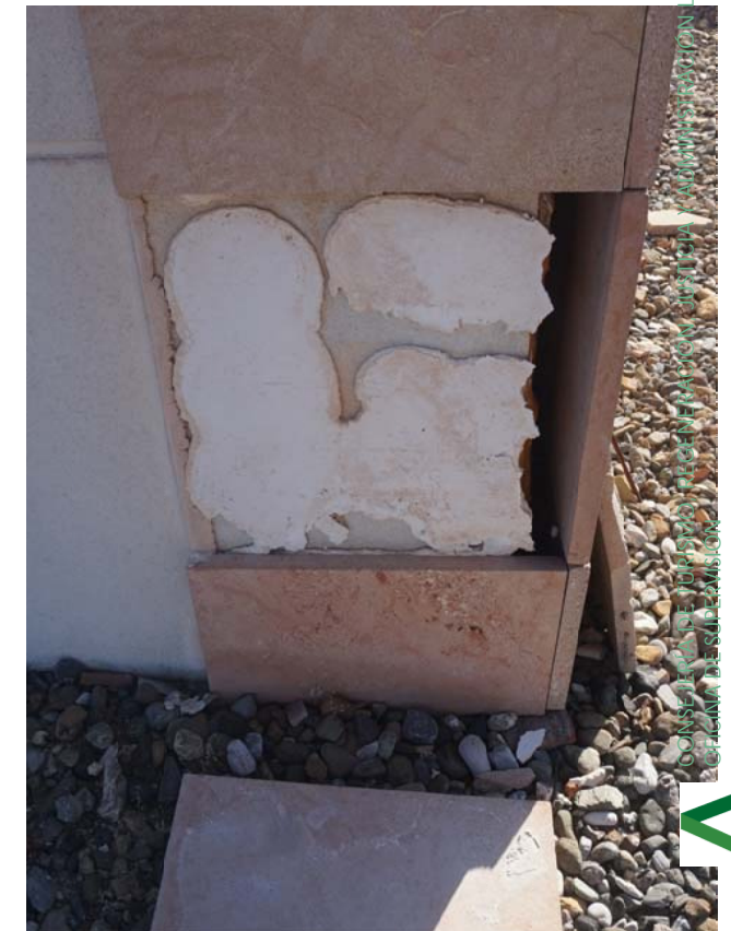
FOTO 8: APLACADO CON SISTEMA DE SUJECIÓN INSUFICIENTE MEDIANTE PELLADAS DE MORTERO
