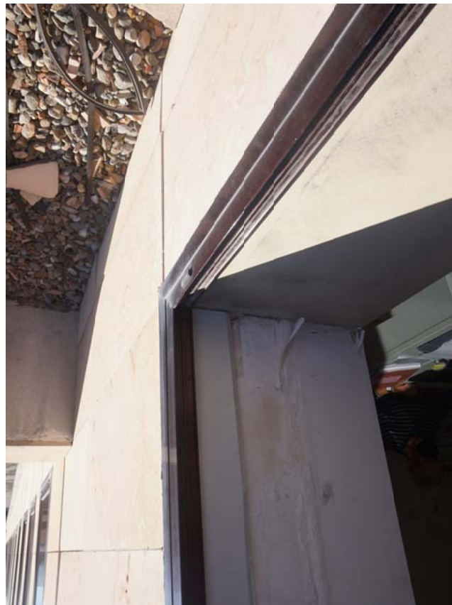
FOTO 4: PRESENCIA DE HUMEDAD EN MOCHETA
