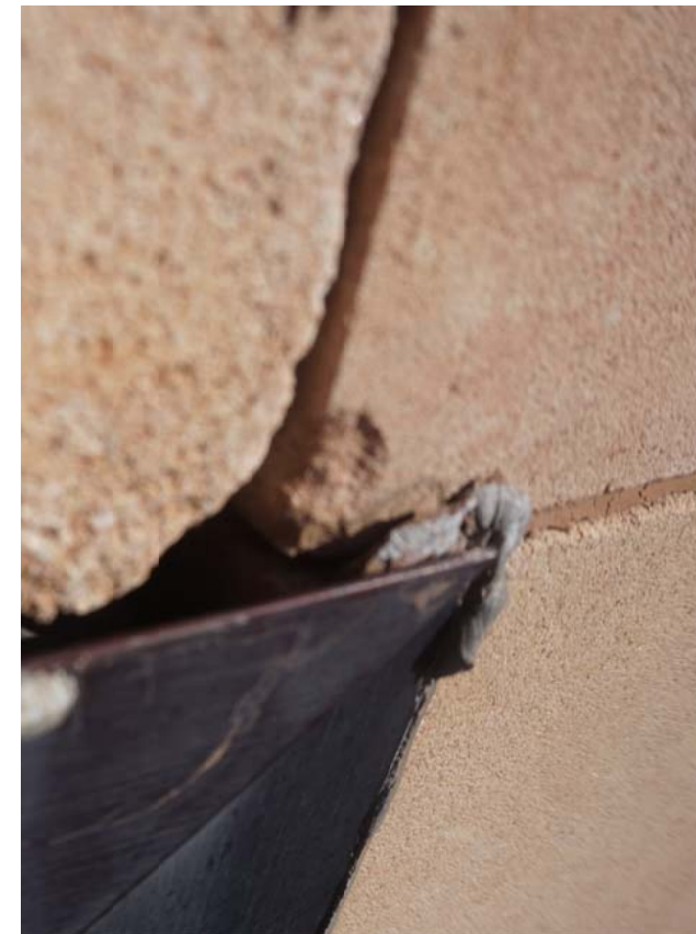
FOTO 7: PIEZAS DE APLACADO DESPORTILLADAS
