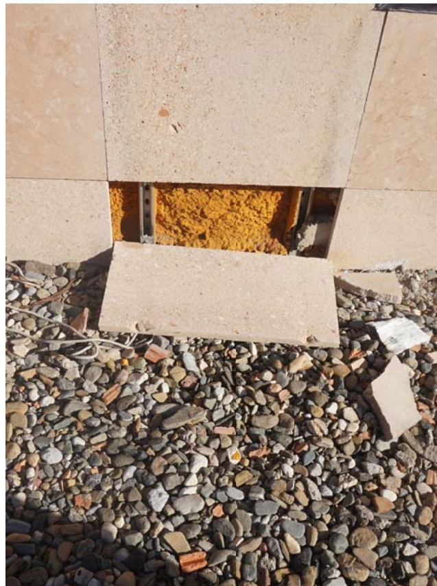
FOTO 2: PIEZA DE FACHADA SIN ANCLAR, DEBIDO AL DEFICIENTE ENLACE DE LOS ELEMENTOS LÍMITE
