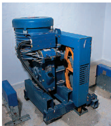
13. MAQUINARIA DE ASCENSOR.
