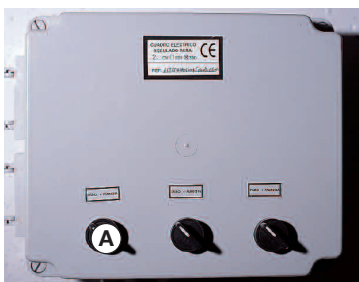
5. CUADRO DE MANDO DE ELECTROBOMBAS:
