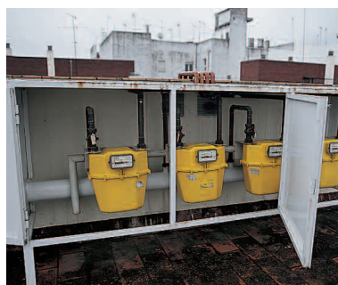
20. BATERÍA DE CONTADORES Y LLAVES DE CORTE.
