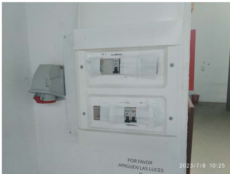
Cuadro eléctrico actual
