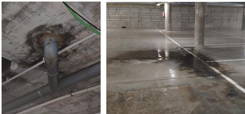
8. Filtración y la formación de una acumulación de agua en los aparcamientos, específicamente cerca de las plazas F-0714, F-0715 y F-0716.
