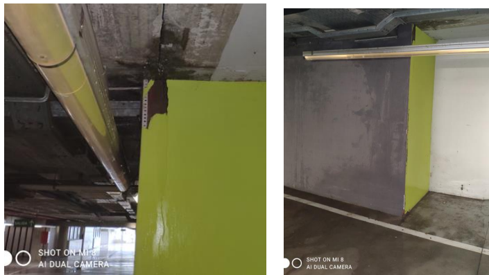
7. Filtración y goteras en la zona de acceso a las escaleras sur del edificio C.
