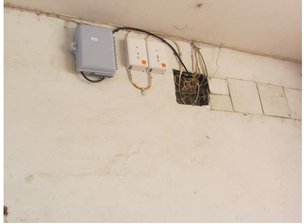
Ausencia de tapa de registro de telefonía
