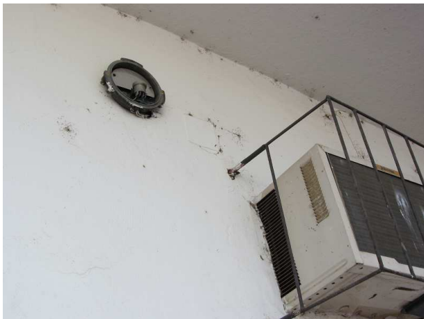
Apliques de pared rotos
