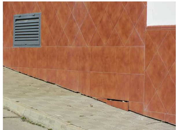
Oxidación de rejilla de ventilación del sótano y desprendimiento de piezas del zócalo perimetral
