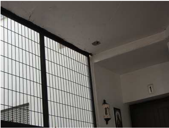
Falta de fijación y anclaje de reja patio
