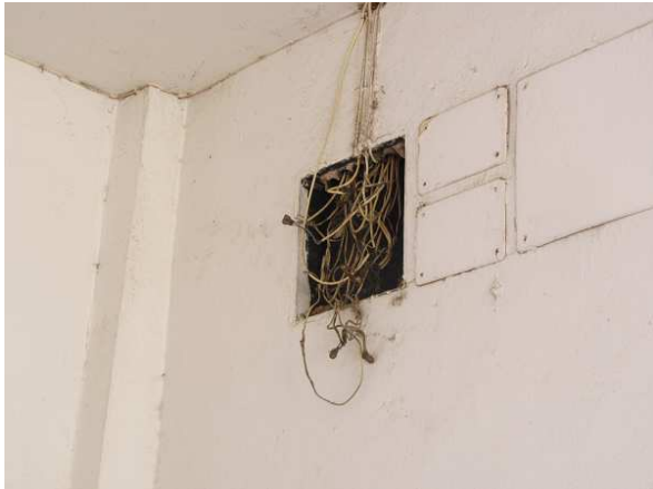
Ausencia de tapas de registros eléctricos y de telefonía
