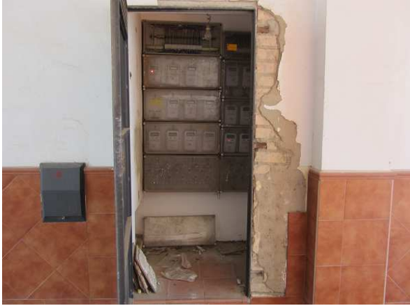
Falta de cerradura homologada y mal recibido de la puerta
