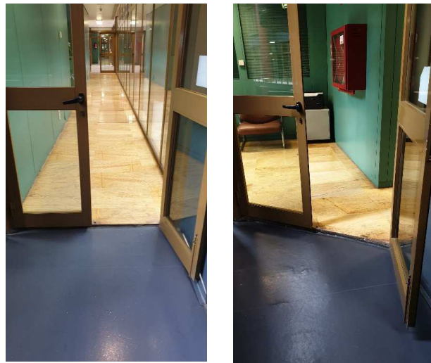
Resaltes en la transición de galería exterior a interiores
