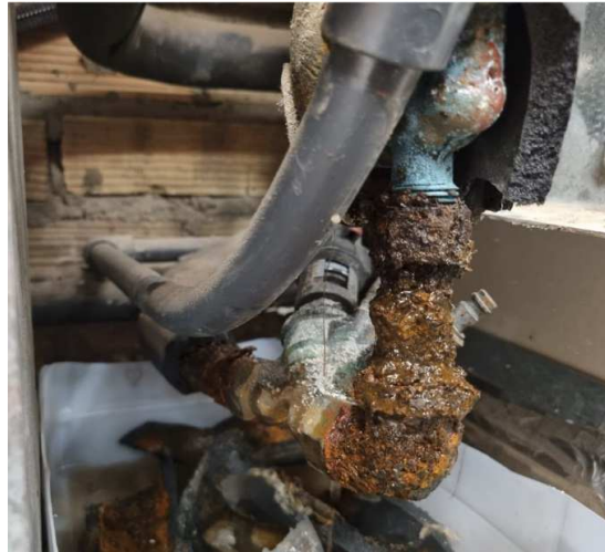
Imagen del deterioro descrito
