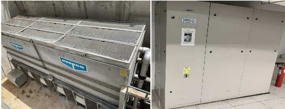
Torre de refrigeración LSWA 87A – equipo CPD Airdata
