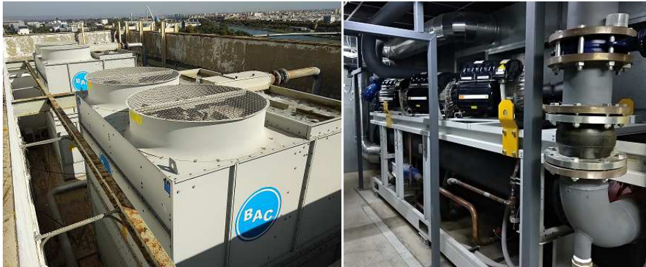
Torre enfriadora BALTICARE / TXV 333 – planta enfriadora TECS2-W/HC 1053
