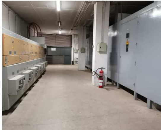
Centro de transformación del edificio.
