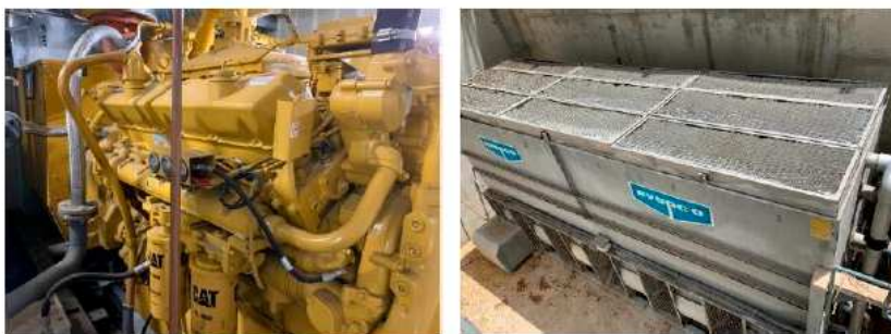
Generador Carterpillar y torre de refrigeración
