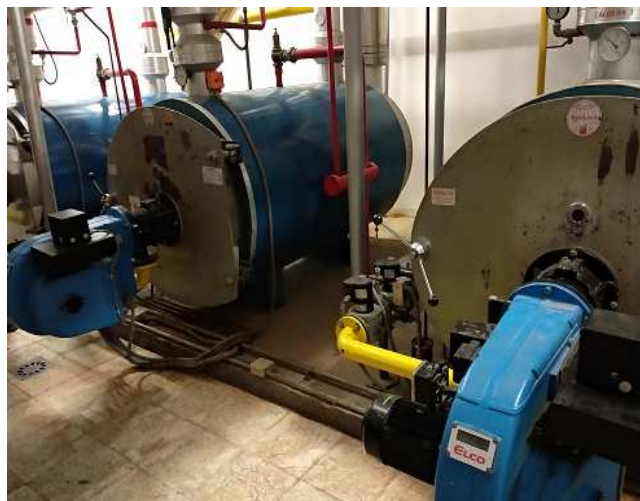
Equipos de producción de agua caliente existentes. Mod. EG4A-1350 de YGMIS.
