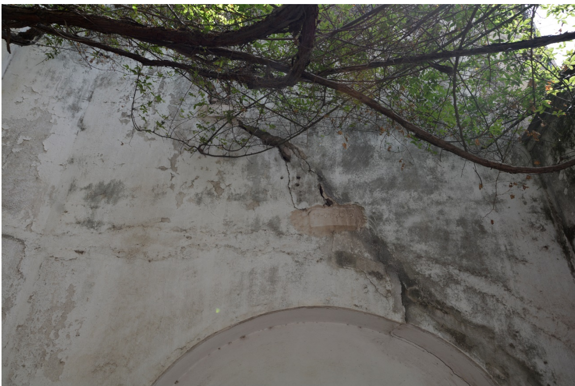
Gran grieta con testigos antiguos en el muro medianero oriental
