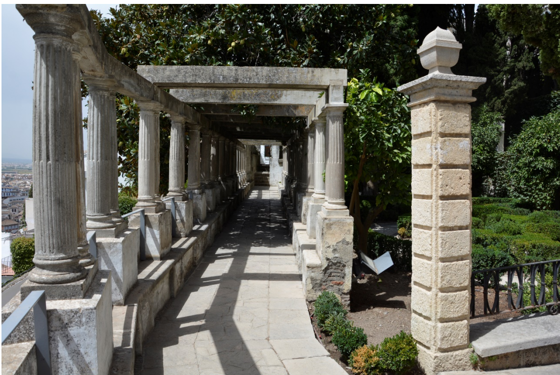
Fracturas en los pilares del jardín bajo que da a la calle Aire Alta
