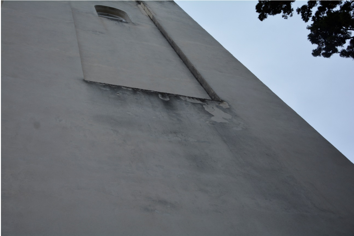
Detalle de mortero de revestimiento desprendido
