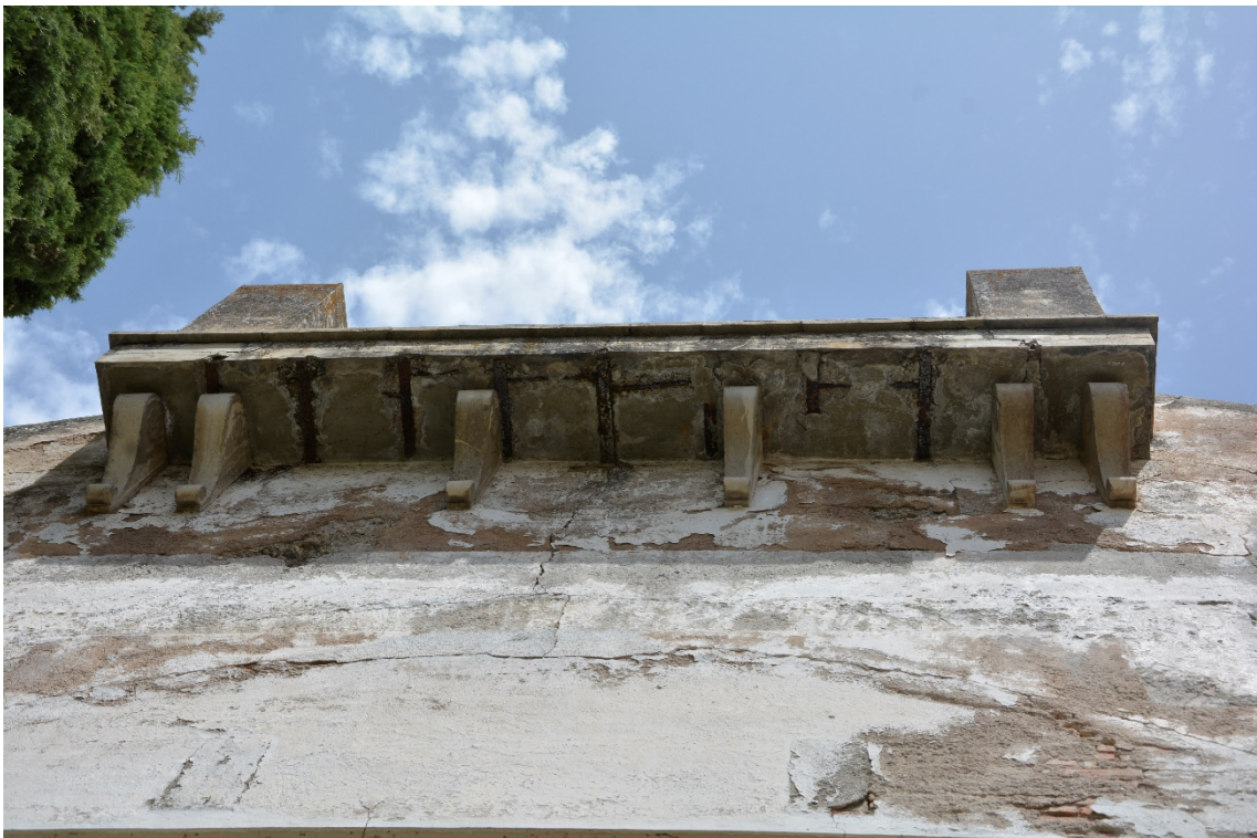
Losa de balcón reventada y estructura metálica oxidada
