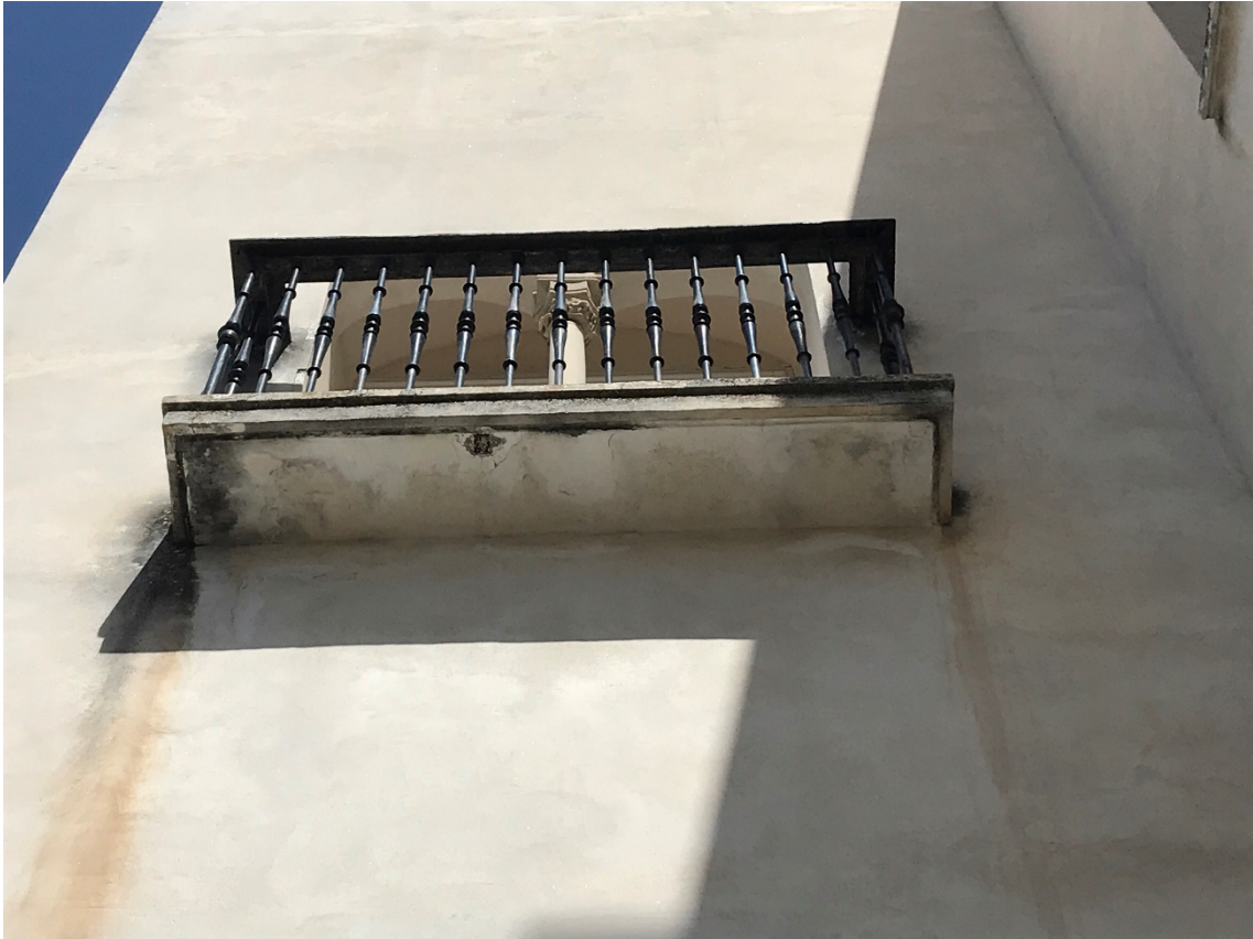
Detalle de losa de balcón con armadura metálica oxidada
