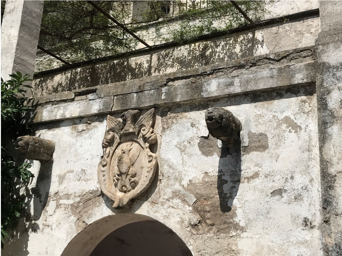
Grietas y fisuras en arco
