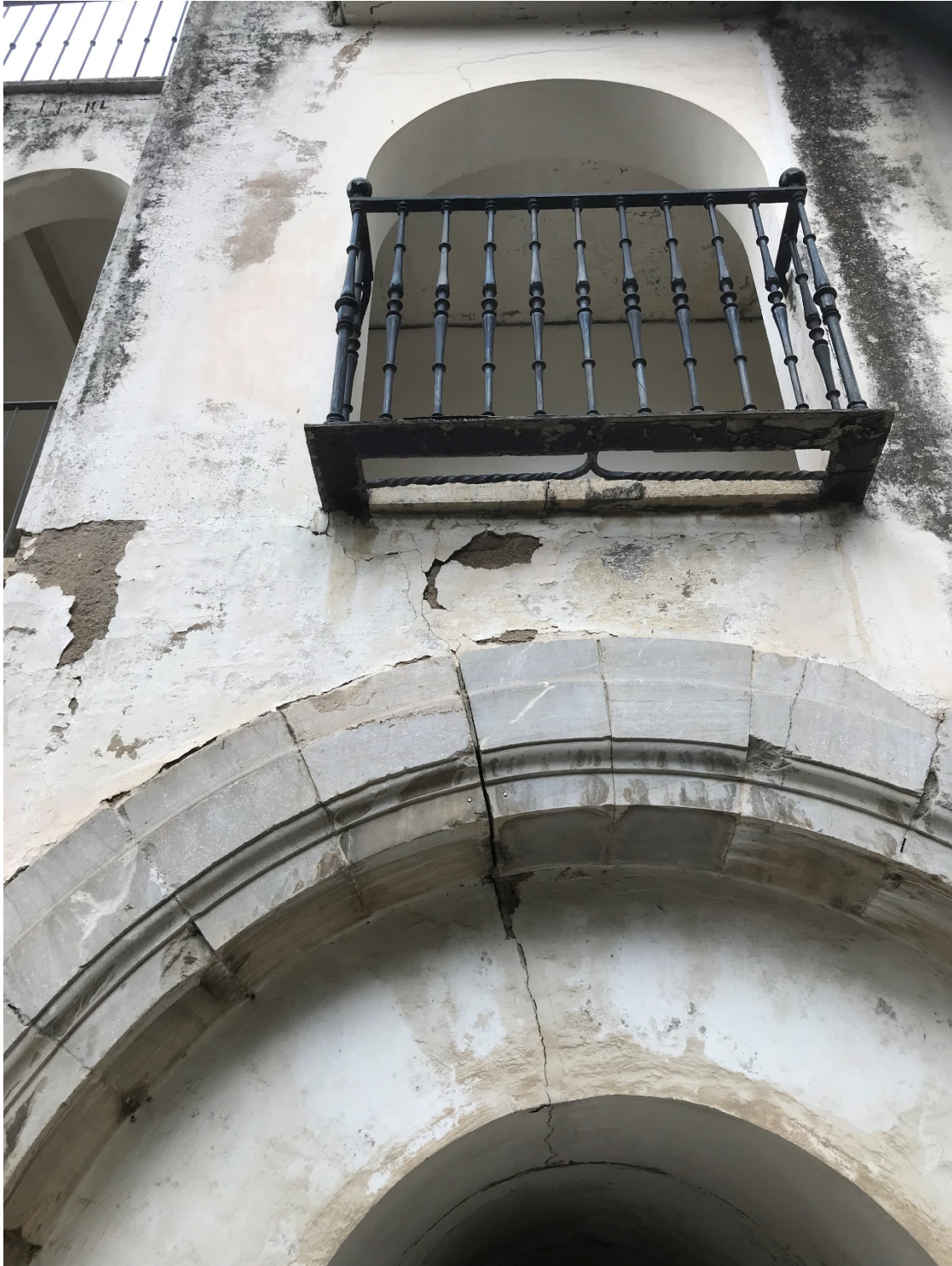
Pieza metálica de soporte para la losa de balcón. Revestimientos de paramentos desprendidos en altura
