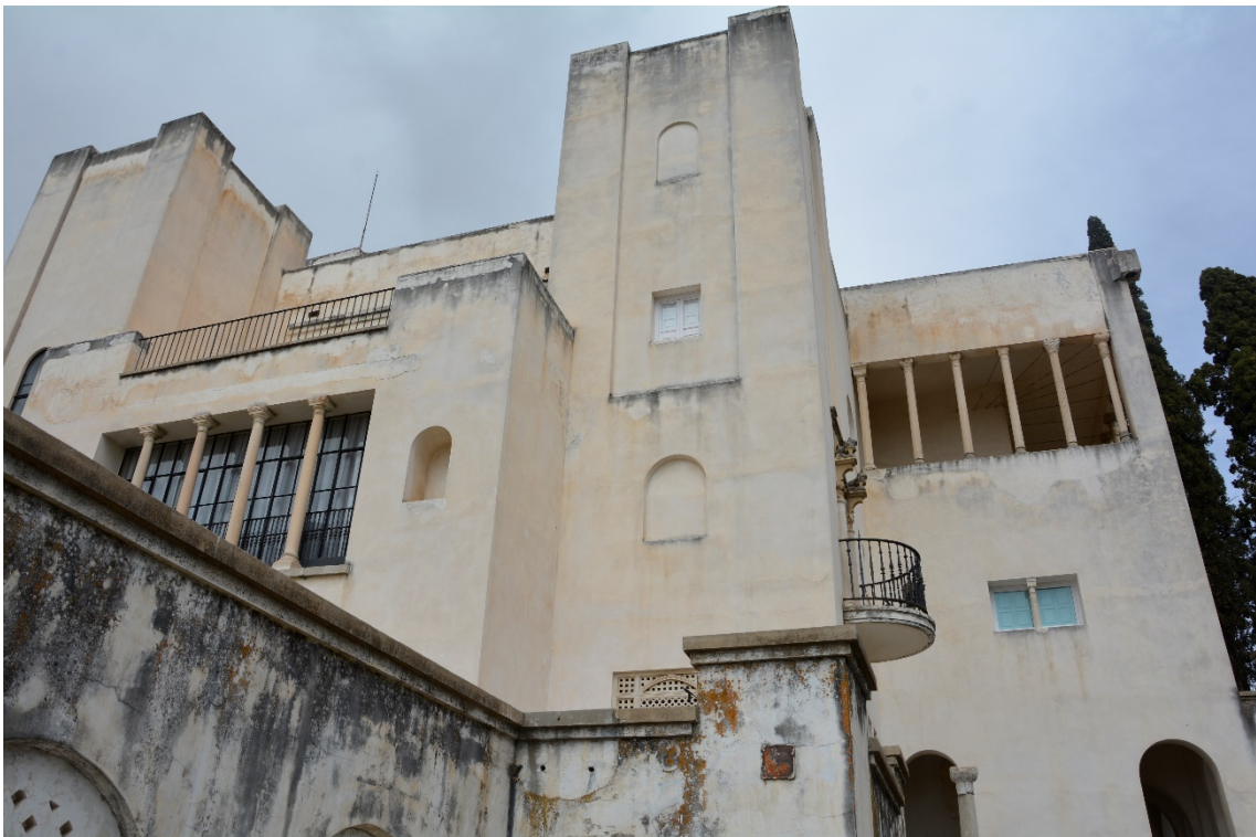
Zonas altas del edificio principal de la fundación con partes desprendidas de revestimiento
