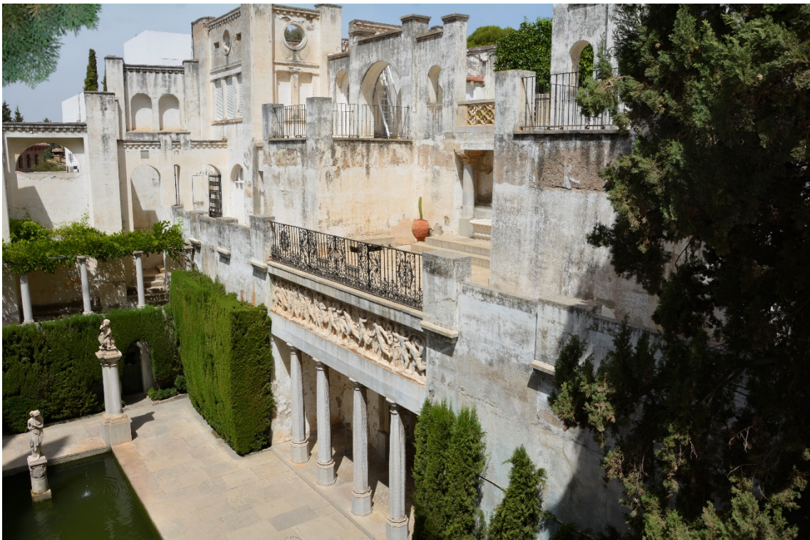
Paramentos superiores de la terraza de Ceres con revestimientos perdidos y soporte inferior disgregado
