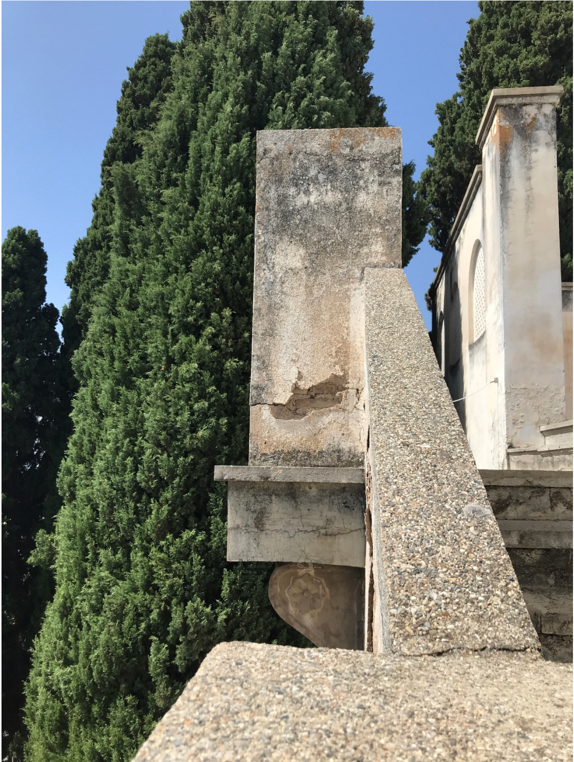
Detalle de revestimiento reventado y en peligro de caída
