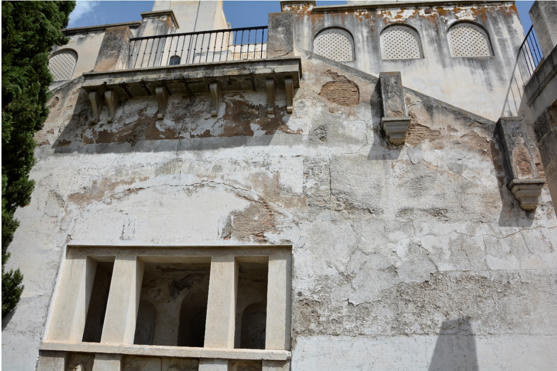
Alzado sur de la escalera del jardín alto con revestimientos desprendidos y grandes lagunas
