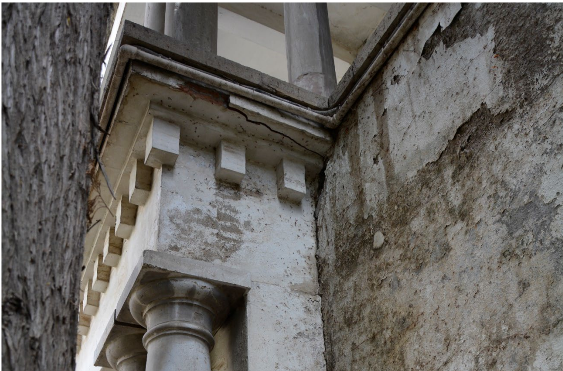
Grieta de canchillos fracturados en el jardín de Venus
