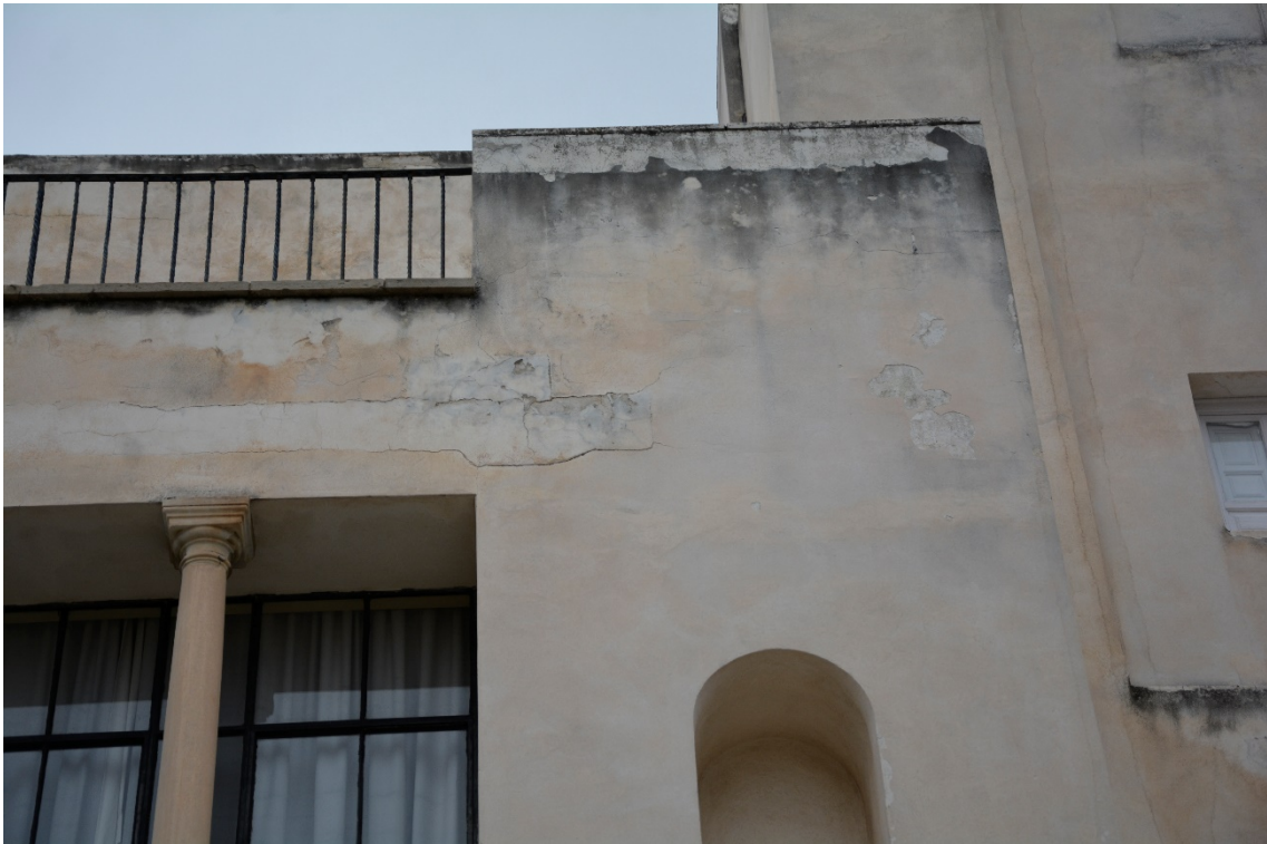
Morteros desprendidos en los bordes superiores de los petos. Grieta a la altura de la viga de ventanal de fachada
