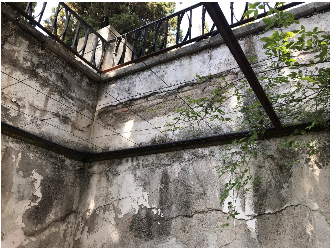
Detalle de deplacado de revestimiento
