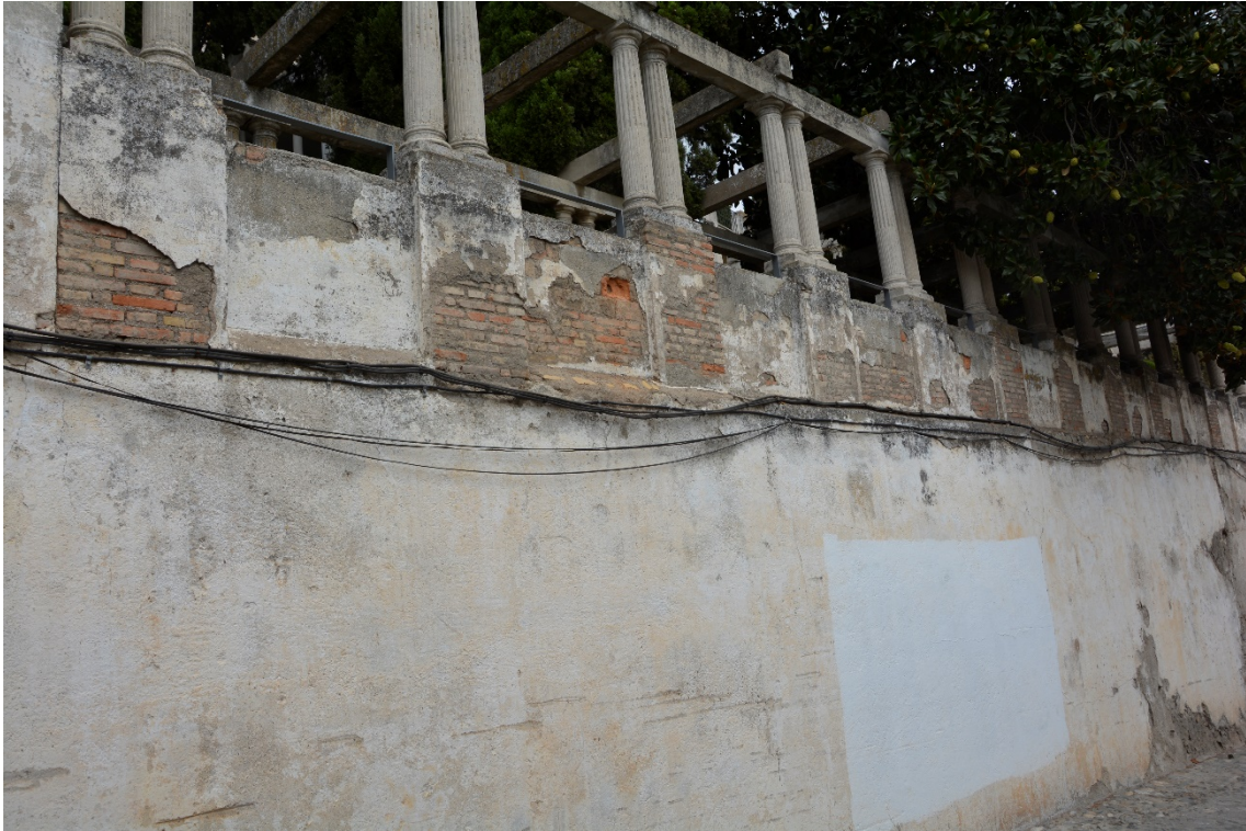
Pilares de la loggia que da al jardín bajo y a la calle Aire Alta y estado de los morteros de revestimiento que dan a la calle con peligro de caída
