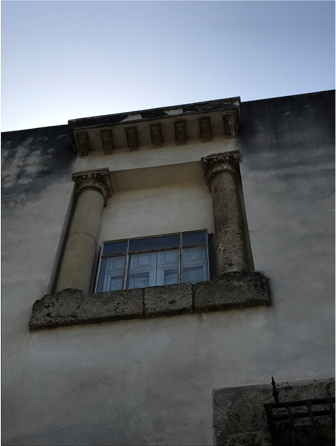
Revestimientos perdidos en cornisa
