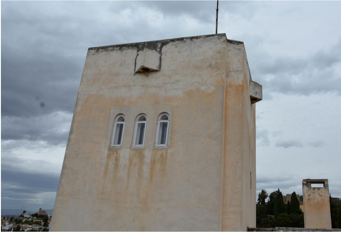
Fisuras bajo la luminaria de la torre y revestimiento craquelado
