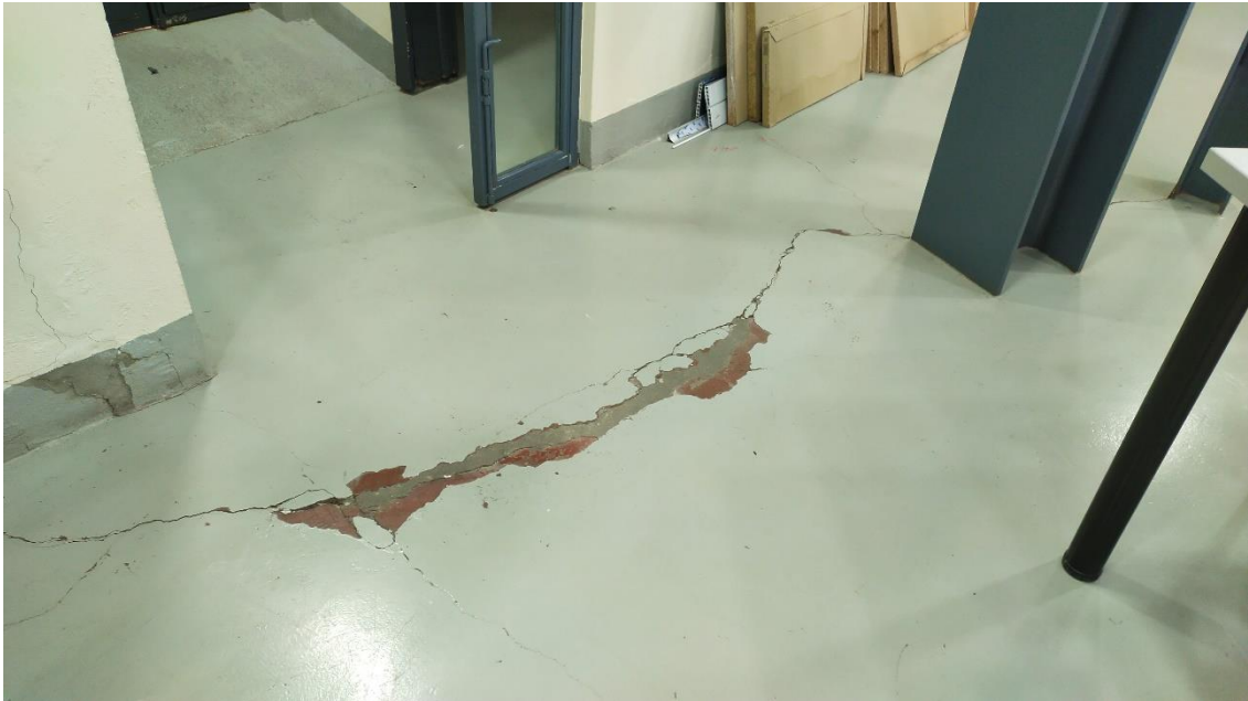
Imagen del interior del comedor, donde se aprecia el deterioro del pavimento
