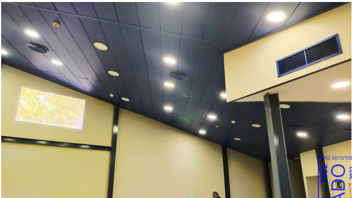
Imágenes del interior del edificio, zona del comedor, con el falso techo a sustituir
