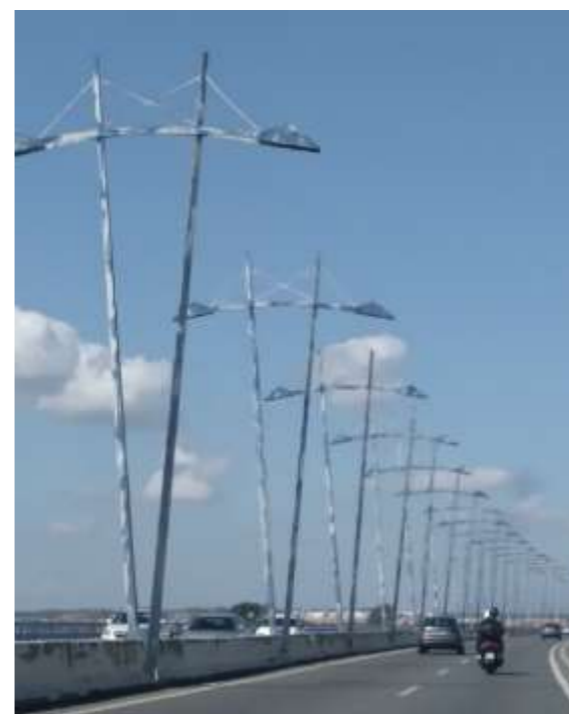
Fotografía 8: el ambiente marino corroe báculos y barreras centrales.
