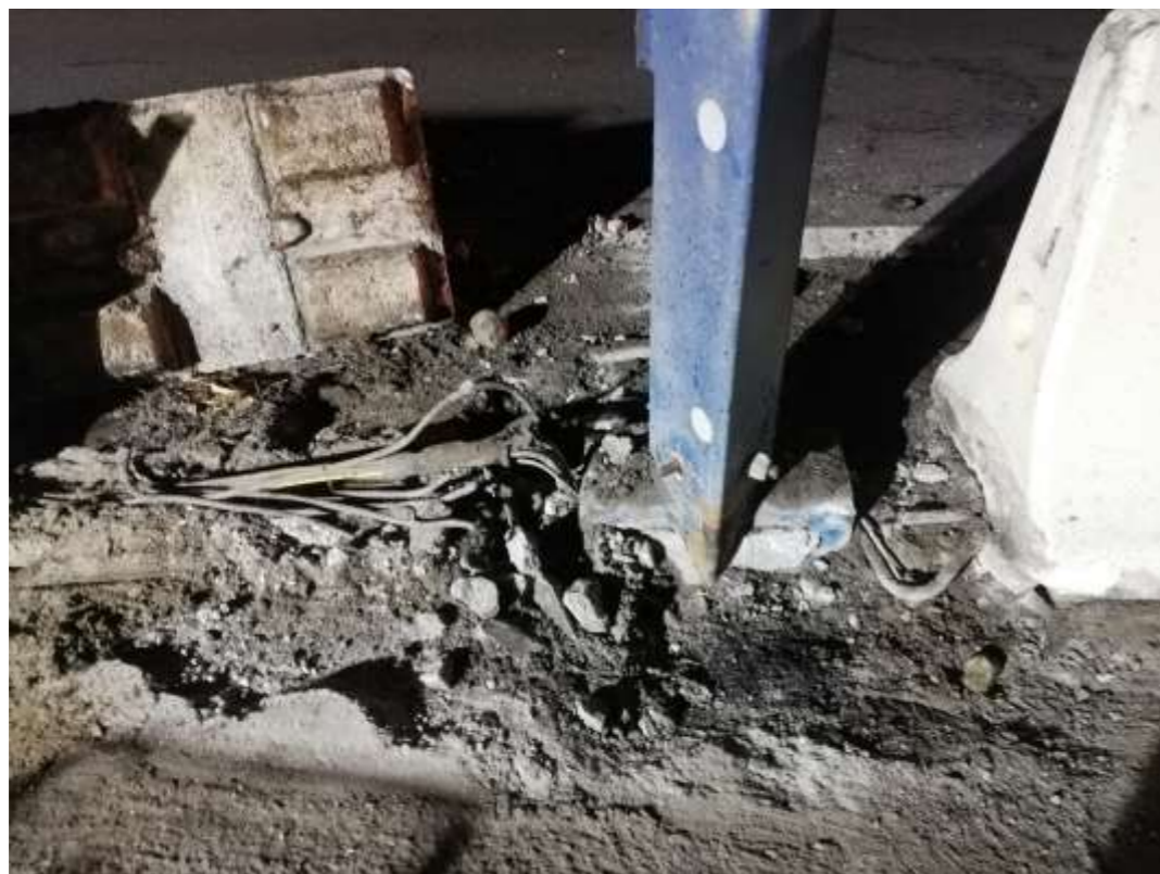
Fotografía 3: Detalle del estado del cableado existente.
