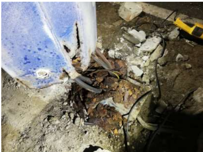
Fotografía 2: Detalle de corrosión en la base del báculo existente.
