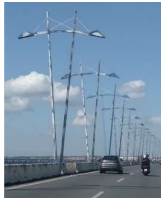
Fotografía 7: nótese cómo algunos báculos presentan mejor estado por haber sido rehabilitados.
