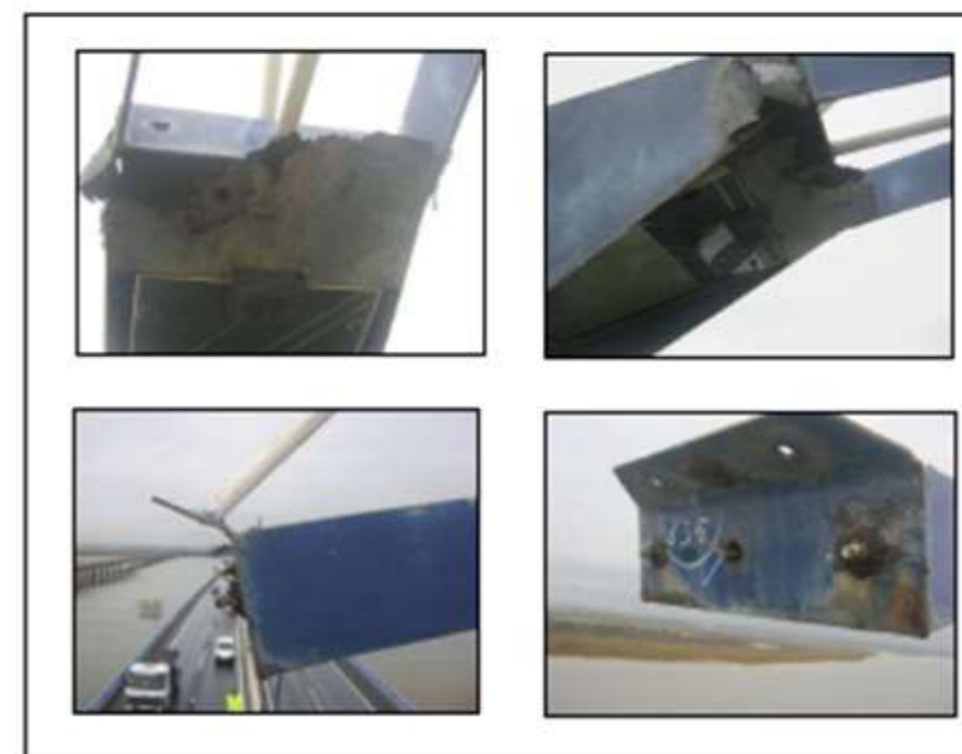
Lámpara sobre calzada sentido Huelva en báculo Nº 22
