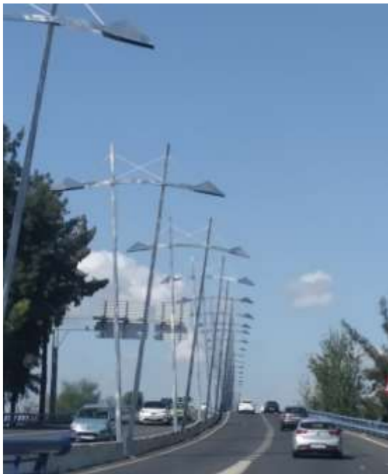
Fotografía 2: nótase el deficiente estado de la pintura de los báculos.
