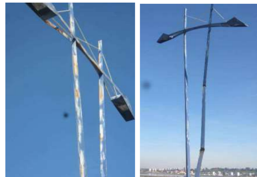
Patología de oxidación y golpeo, báculo B67
