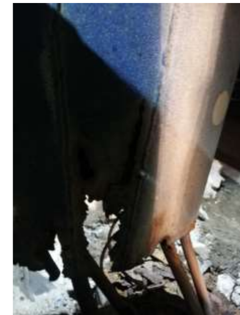
Fotografía 1: Detalle de corrosión en la base del báculo existente.
