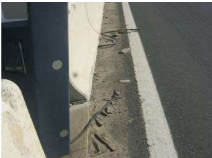
Cableado de alimentación seccionado
