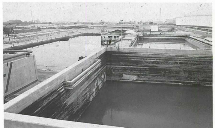
Balsa de homogeneización y control de PH
