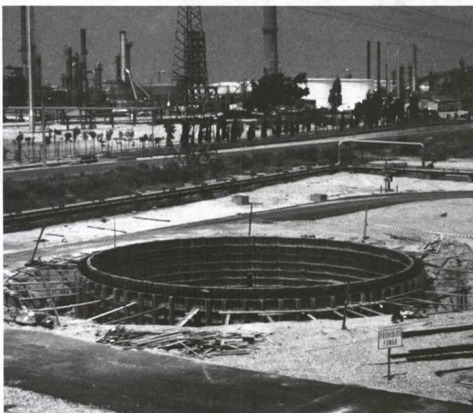
CONSTRUCCION DE INSTALACIONES CORRECTORA DE LA CONTAMINACION EN EL POLO DE HUELVA.
