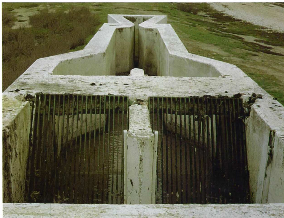
Zona de pretratamiento y reja de grueso en laguna de oxidación en La Lantejuela (Sevilla).
