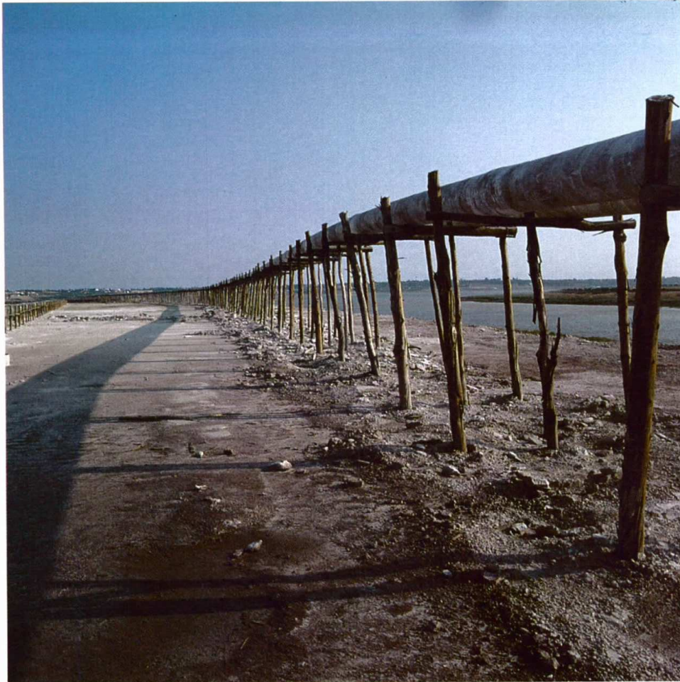
Tubería de transporte para los yesos que desaparecerá una vez ejecutada la obra.
