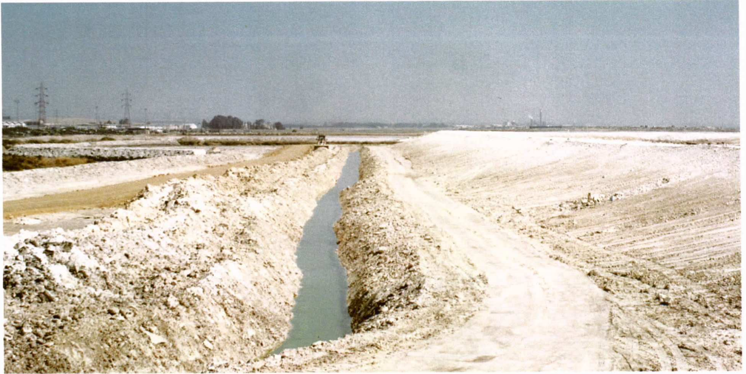
Zanja perimetral de recogida de las aguas a través de los diques formados por la pila de yesos.
