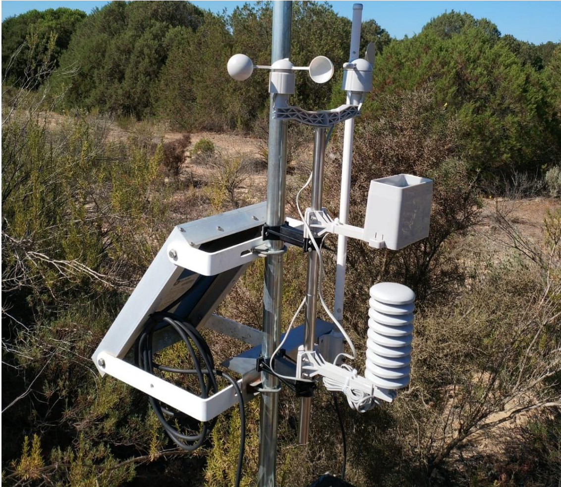
Figura 2. Instalación de nodo terminal (detalle de sensores méteo del nodo #10).
