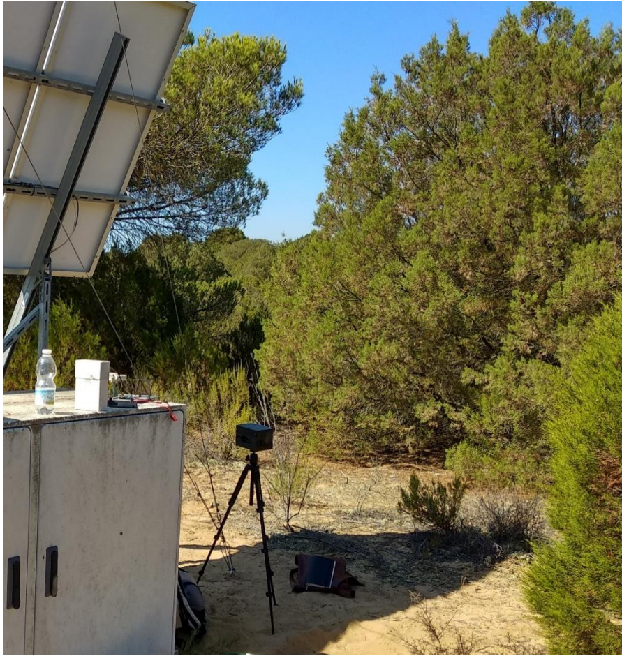
Figura 5. Nodo con cámaras térmica y visible en Torre del Ojillo.
