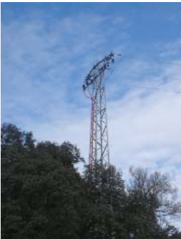
Las líneas eléctricas deben evitar los puntos culminantes del relieve.
