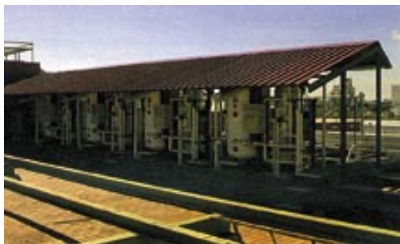
Banco de ensayo de equipos solares-térmicos desarrollado por el Instituto Andaluz de Energías Renovables
