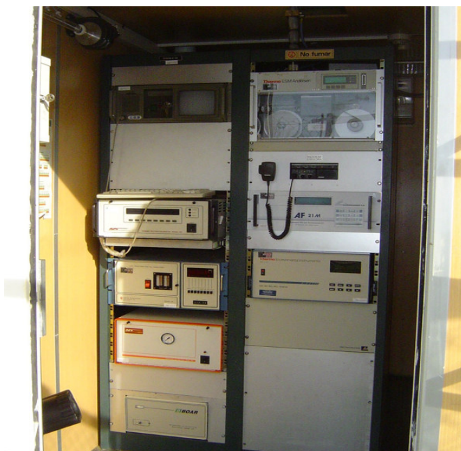
Figura 5. Equipos de medida automáticos en las estaciones de la RVCAA.
