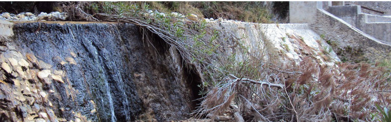
Cabecera del Río Chillar (Málaga). Detalle de azud. Derivación de agua para la Fábrica de la Luz. D. Cabello.
