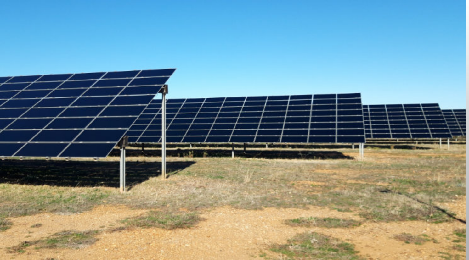
Placas fotovoltaicas, Guadix (Granada). P. Flores.
