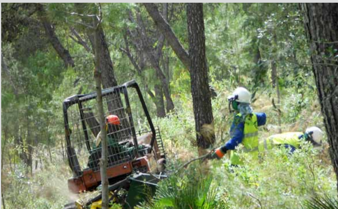
Astillado de residuos ejecutado por una astilladora alimentada por dos peones forestales en el T.M. Montellano (Sevilla). (Obra 08_SE_226_5_2 Actuaciones selvícolas de prevención de incendios y restauración en los montes de Montellano).
