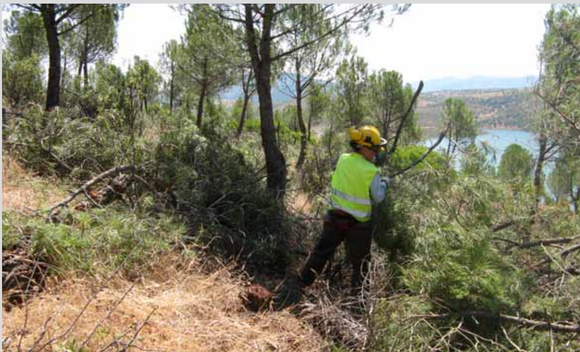
Operario realizando apilado de residuos en el T.M. Chiclana de Segura (Jaén). (Obra 06_JA_226_123_4 Actuaciones selvícolas de mejora de la productividad de pino piñonero m/ "Las Beatas").
