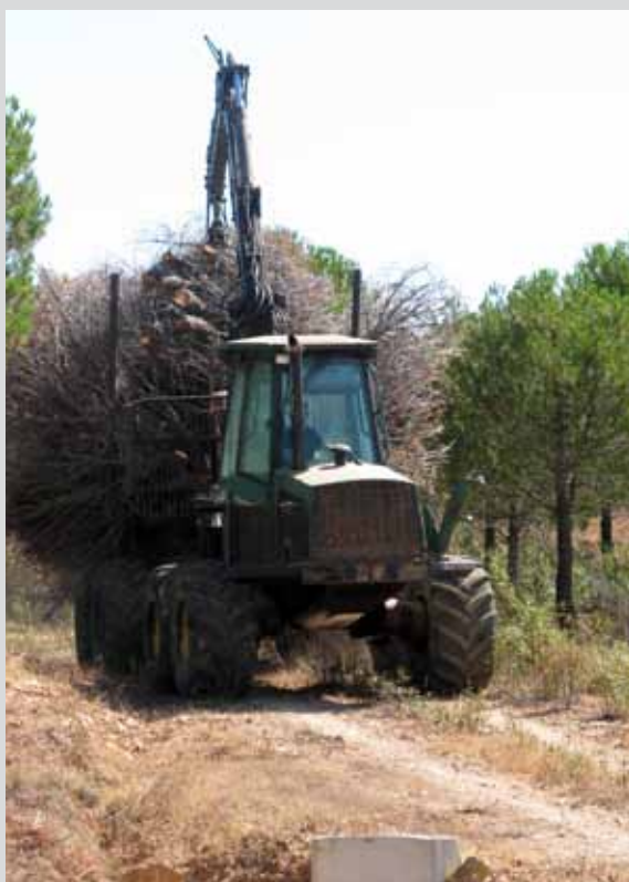
Autocargador sacando pinos en el T.M. El Castillo de las Guardas (Sevilla). (Obra 08_SE_226_123_2 Actuaciones selvícolas de prevención de incendios en los montes públicos de El Madroño, El Castillo de las Guardas, El Ronquillo y el Corredor Verde del Guadiamar).
