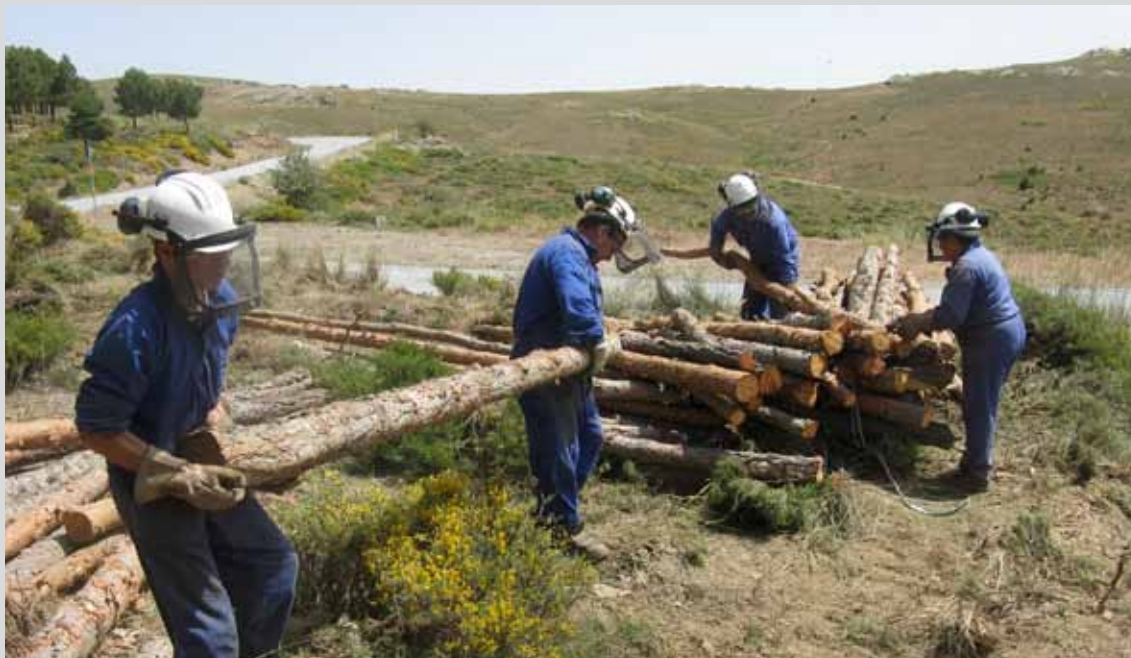
Cuadrilla de trabajadores apilando y clasificando madera en el T.M. Abia (Almería). (Obra 01_AL_226_4_1 Tratamientos selvícolas de conservación y mejora de masas forestales en montes públicos ubicados en el sector occidental de la provincia de Almería).
