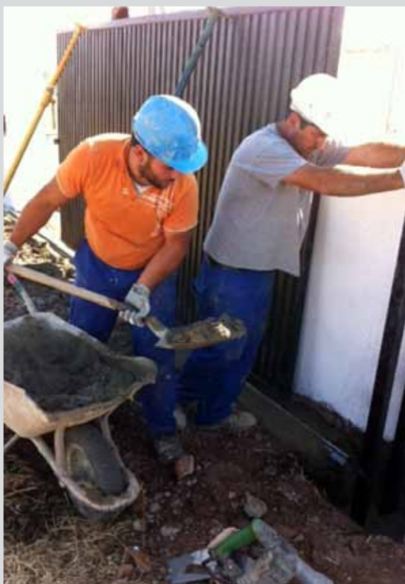
Operarios realizando trabajos de albañilería en el T.M. Canjáyar (Almería). (Obra 01_AL_323_2 Contrato menor “Aprisco de Ganado”).
