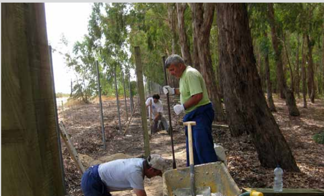
Cuadrilla de peones colocando vallado metálico en el T.M. Bonares (Huelva). (Obra 05_HU_323_1 Proyecto de restauración, mejora y puesta en valor del patrimonio rural en montes públicos de la provincia de Huelva).
