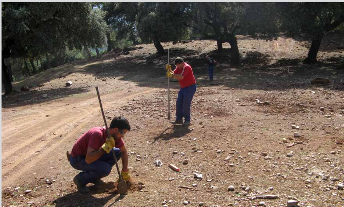
Cuadrilla de peones realizando hoyos para cerramiento con malla de alambre en el T.M. Hornos (Jaén).
