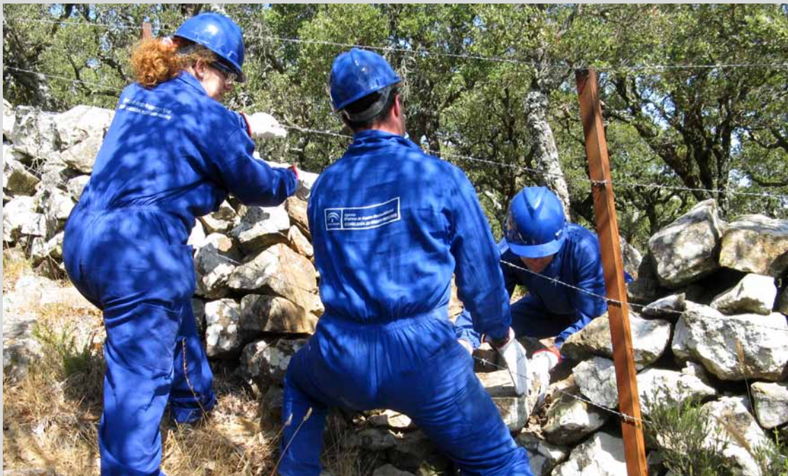
Personal trabajando en muro de mampostería en el T.M. Alcalá de los Gazules (Cádiz). (Obra 02_CA_323_1 proyecto de restauración, mejora y puesta en valor del patrimonio rural en montes públicos de la provincia de Cádiz).
