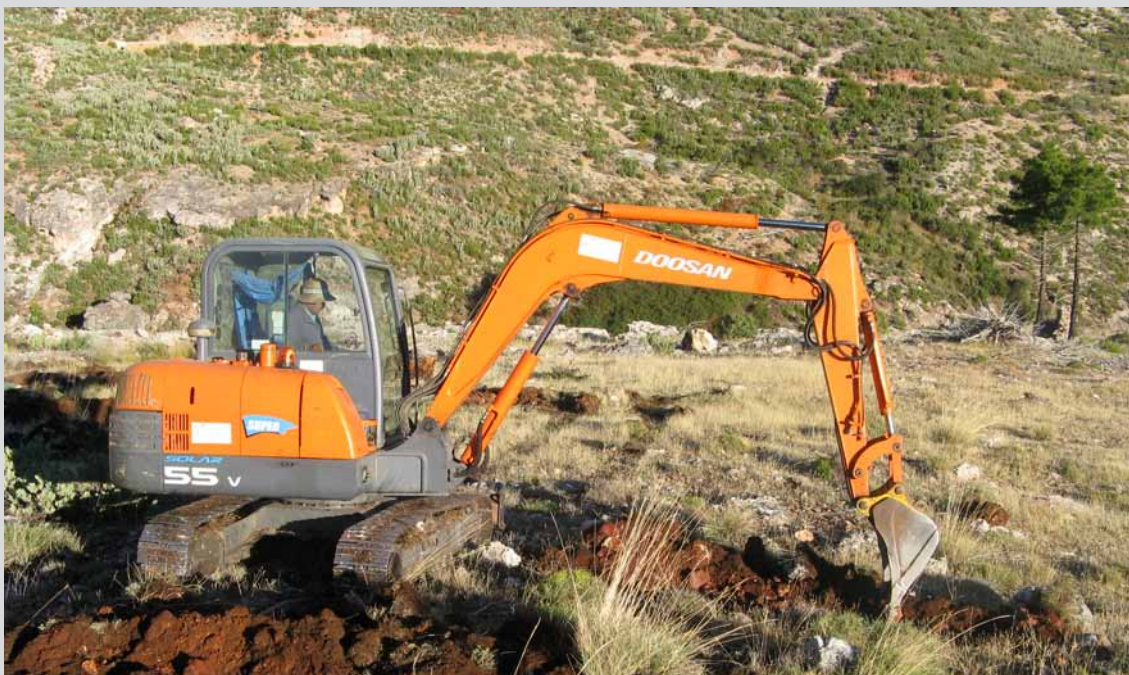
Retroexcavadora realizando ahoyado mecanizado en el T.M. Villanueva del Arzobispo (Jaén). (Obra 06_JA_226_4_1 Actuaciones selvícolas de prevención de incendios, de mejora productora, de corrección hidrológica y restauración en el "P.N. Cazorra, Segura y las Villas" (Sierras de Cazorra y las Villas).
