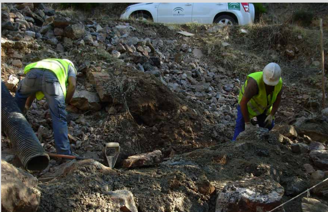
Operarios realizando trabajos de albañilería en el T.M. Santa Elena (Jaén). (Obra 06_JA_323_2 Mejora del patrimonio rural en el "Parque Natural de Despeñaperros").
