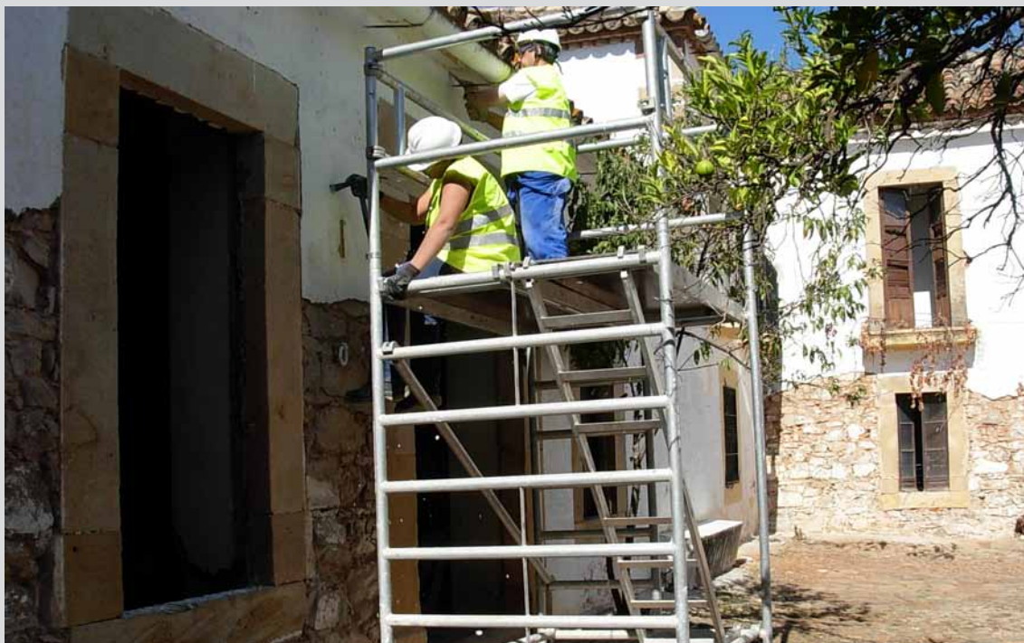
Operarios realizando trabajos de albañilería en el T.M. Montoro (Córdoba). (Obra 03_CO_323_1 Proyecto de restauración, mejora y puesta en valor del patrimonio rural en montes públicos de la provincia de Córdoba).
