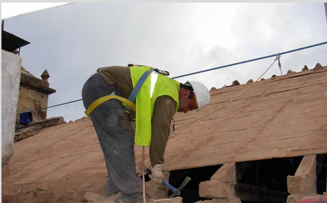
Trabajos en cubierta en el T.M. Montoro (Córdoba). (Obra 03_CO_323_1 Proyecto de restauración, mejora y puesta en valor del patrimonio rural en montes públicos de la provincia de Córdoba).
