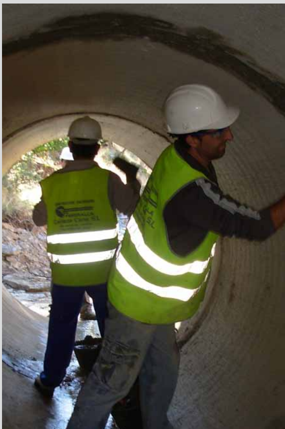
Trabajos de albañilería en el T.M. Santa Elena (Jaén). (Obra 06_JA_323_2 Mejora del patrimonio rural en el "Parque Natural de Despeñaperros").
