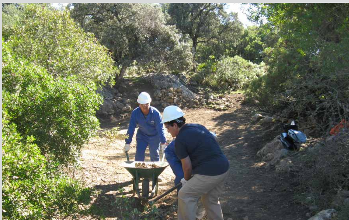
Excavación manual en el T.M. Benaocaz (Cádiz). (Obra 02_CA_323_1 proyecto de restauración, mejora y puesta en valor del patrimonio rural en montes públicos de la provincia de Cádiz).
