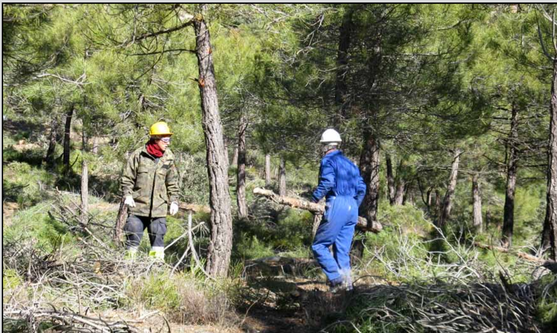
Recogida y apilado de residuos en el T.M. Valle del Zalabí (Granada). (Obra 04_GR_226_5_1 TT.SS. de prevención de incendios forestales y de mejora de la capacidad productora de biomasa forestal de uso energético y de pastos en TT.MM. de las comarcas de Baza, Guadix y Huéscar de la provincia de Granada).
