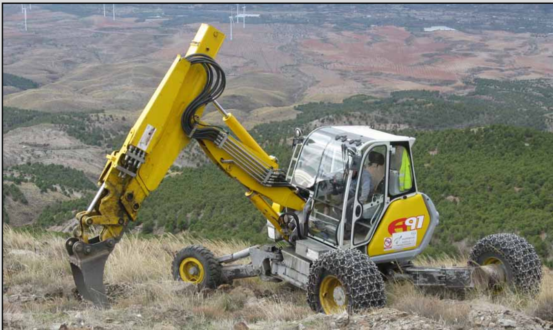
Apertura de hoyos con retroaraña en el T.M. Fiñana (Almería). (Obra 01_AL_227_5_1 Mantenimiento y conservación de ecosistemas en la provincia de Almería).
