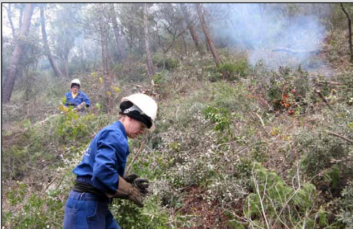
Quema controlada de residuos en el T.M. Beas de Segura (Jaén). (Obra 06_JA_226_5_2 Actuaciones selvícolas de prevención de incendios, de mejora productora, de corrección hidrológica y restauración en el "PN Cazorla, Segura y las Villas". Sierra de Segura).
