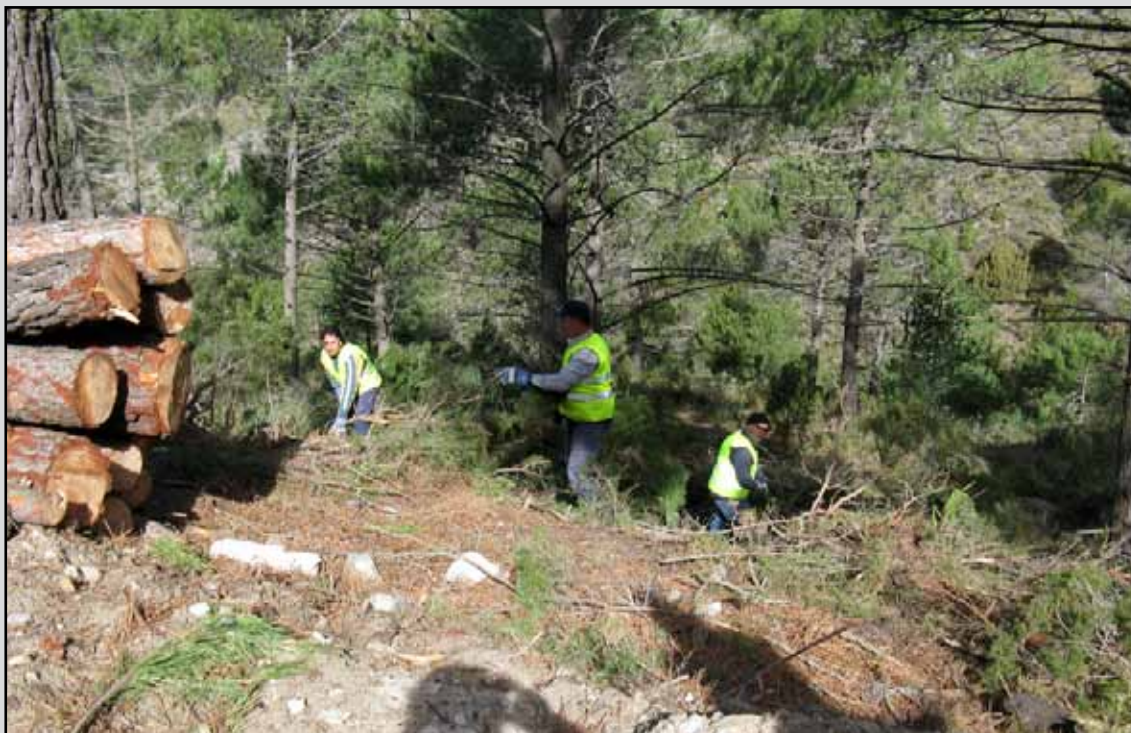
Recogida y apilado de residuos en el T.M. Canillas de Aceituno (Málaga). (Obra 07_MA_226_4_1 Tratamientos selvícolas preventivos en montes del PN Tejeda-Almijara y Alhama y la comarca de Guadalteba. Málaga).
