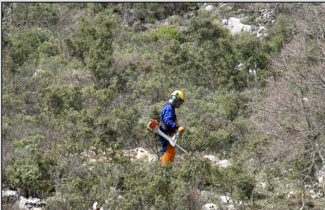
Desbroce de vegetación con motodesbrozadora en el T.M. El Burgo (Málaga). (Obra 07_MA_226_F2_2 Recuperación de potencial forestal e implantación de medidas preventivas en montes de la comarca de la Sierra de las Nieves y serranía de Ronda. Málaga).
