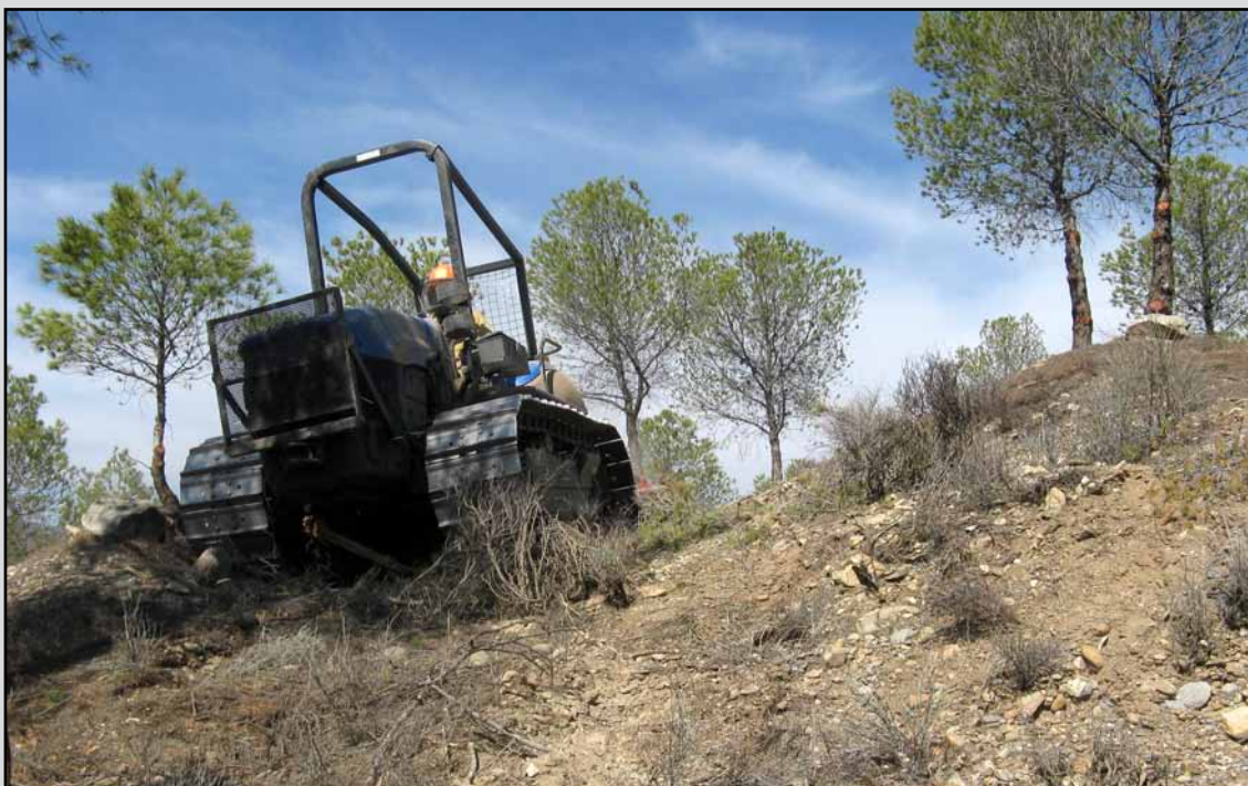
Desbroce de vegetación con desbrozadora de cadenas en el T.M. Alhabia (Almería). (Obra 01_AL_226_123_2 Tratamientos selvícolas preventivos y de mejora de los montes en Sierra Nevada (Almería) y Sierra de Gádor).
