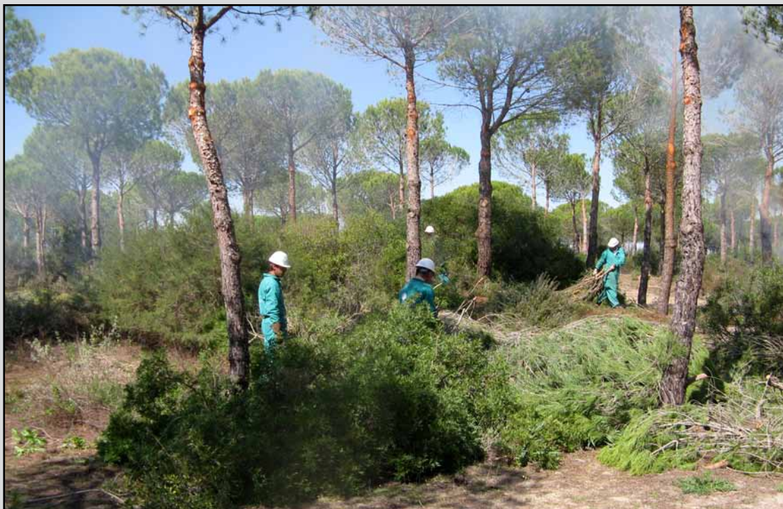
Quema controlada de residuos en el T.M. Sanlúcar de Barrameda (Cádiz). (Obra 02_CA_227_123_3 Restauración de hábitats en el espacio natural Doñana. provincia de Cádiz).
