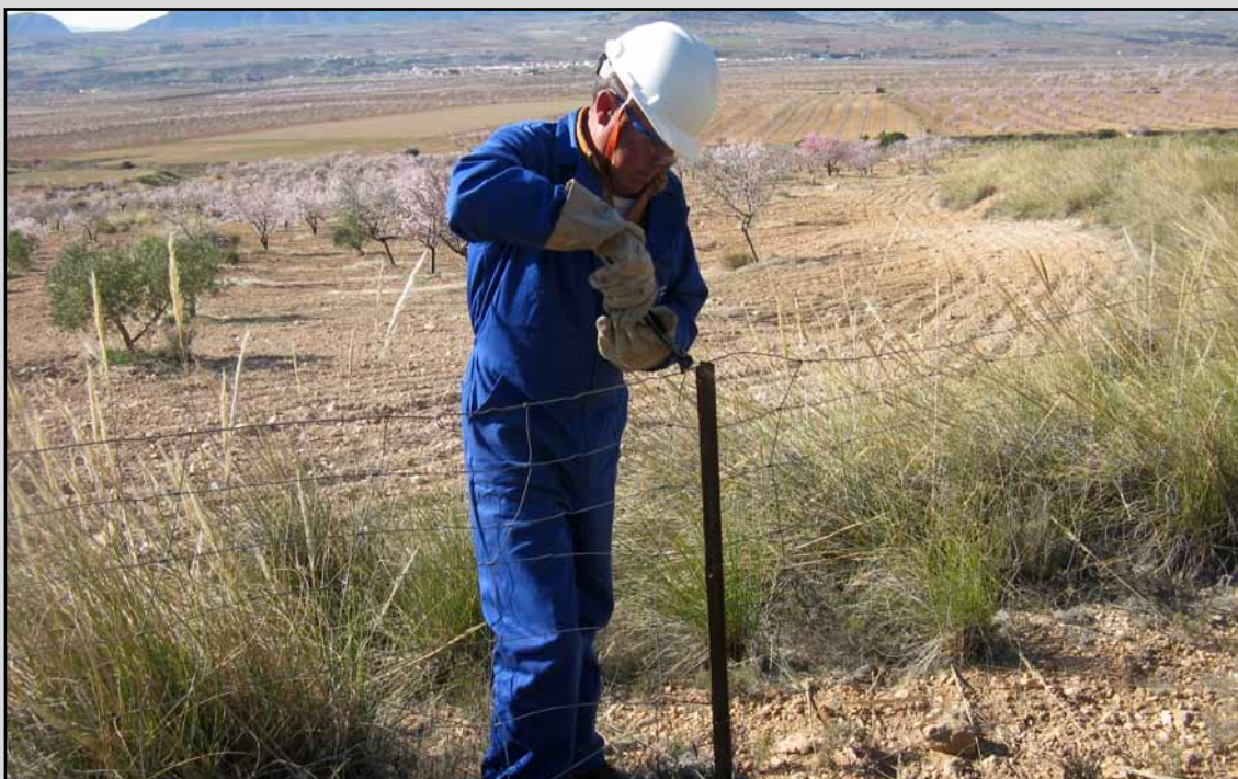
Retirada de vallado en el T.M.Chirivel (Almería). (Obra 01_AL_226_F2_1 Recuperación del potencial forestal; retirada de protectores y cerramientos en reforestaciones de los montes públicos de Almería).
