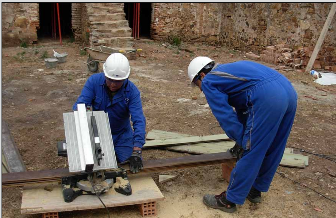
Trabajos de carpintería en el T.M. Villanueva del Rey (Córdoba). (Obra 03_CO_323_1 Proyecto de restauración, mejora y puesta en valor del patrimonio rural en montes públicos de la provincia de Córdoba).
