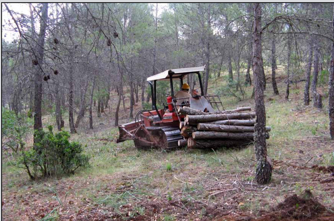
Saca de madera en el T.M. Hornos (Jaén). (Obra 06_JA_226_123_1 Actuaciones selvícolas de prevención de incendios, de mejora productora, de corrección hidrológica y restauración en el "PN Cazorla, Segura y las Villas").
