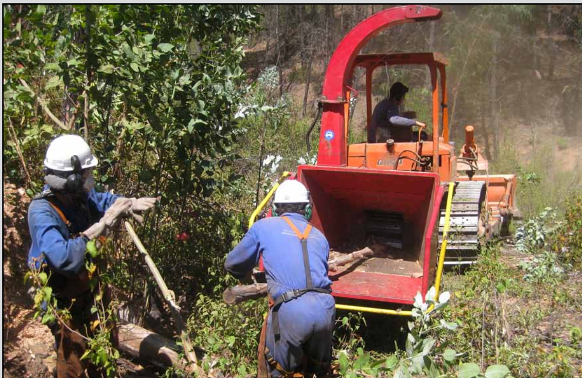
Astillado de residuos en el T.M. Niebla (Huelva). (Obra 05_HU_226_F2_3 Mejora del potencial biológico y forestal tras incendio en monte público Baldíos de Niebla. Huelva).
