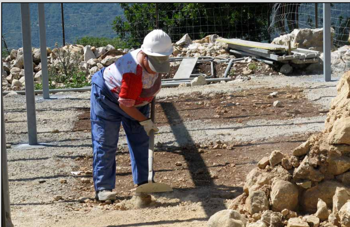
Preparación para construcción de solera en el T.M. Benaocaz (Cádiz). (Obra 02_CA_323_F2 Proyecto de restauración, mejora y puesta en valor del patrimonio rural en MM.PP. de la provincia de Cádiz).
