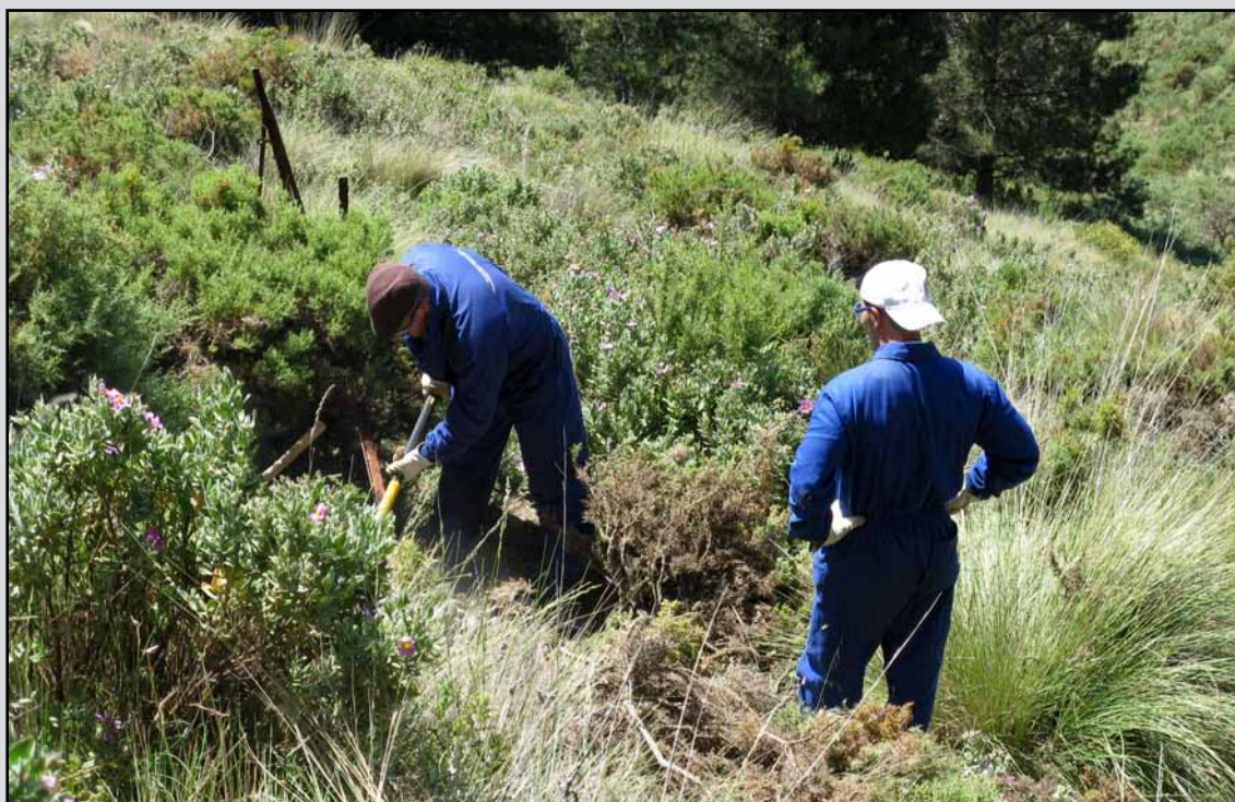
Mantenimiento cercado de protección en el T.M. Salares (Málaga). (Obra 07_MA_227_5_1 Actuaciones mejora de habitats y adecuación de infraestructuras de uso público en montes públicos de Málaga).
