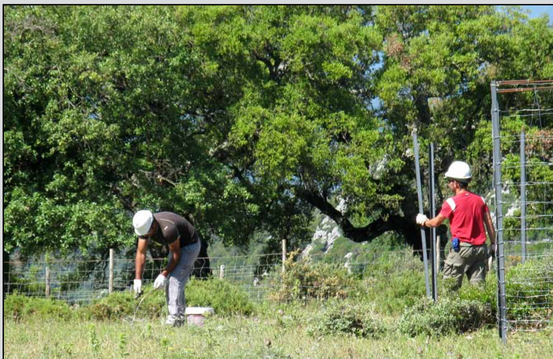
Reparación malla cinegética y protectores de repoblación para el ganado en el T.M. Cortes de la Frontera (Málaga). (Obra 07_MA_227_5_1 Actuaciones mejora de habitats y adecuación de infraestructuras de uso público en MM.PP. de Málaga).
