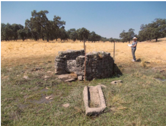
Foto 52. Brocal de un pozo construido con piedras en deficiente estado de conservación y abrevadero adjunto de una sola pieza.
