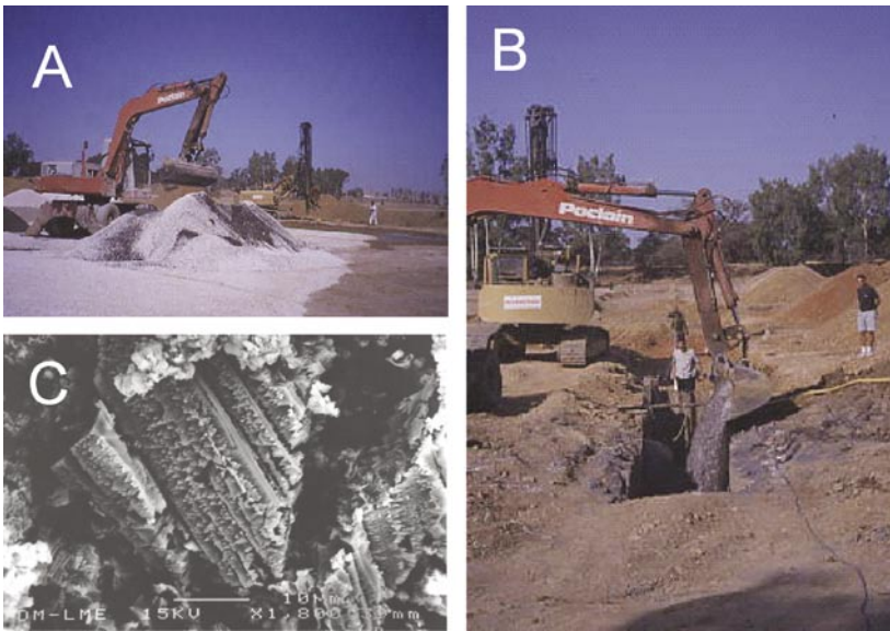
Foto 2. A) Acumulación y mezcla de grava de calcita y compost vegetal. B) Relleno de la zanja con la mezcla realizada. C) Cristales de calcita del relleno de la barrera corroídos por el agua ácida.
