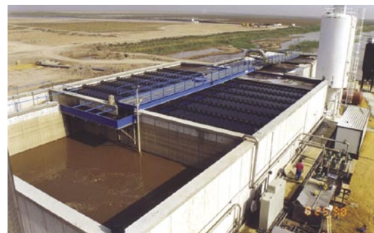
Foto 20. Depuradora para limpieza de aguas ácidas ubicada en Entremuros. Foto: CMA.
