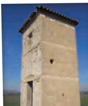
Antiguo transformador de la luz para su rehabilitación
