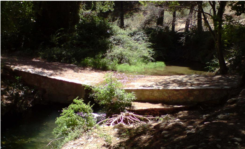
Dique nº 3, delimita franja contención de aprox 1 km de tramo en caso de expansión incontrolada de la población residente aguas abajo
