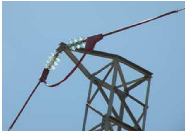
Dispositivos antielectrocución colocados en el tendido eléctrico de Coto del Rey
